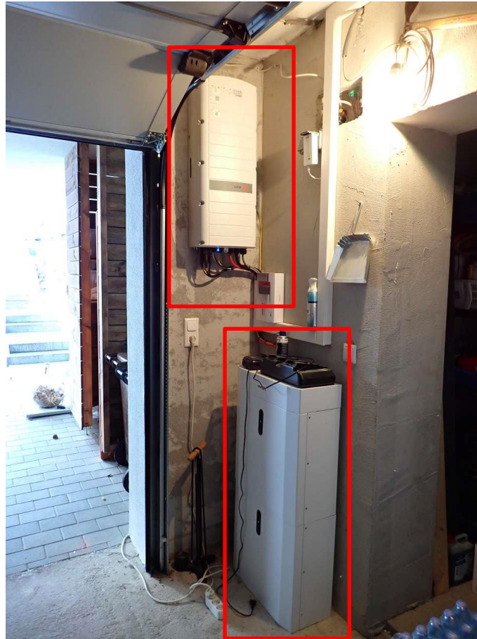
Abbildung 11: Übersichtsbild Garage Wechselrichter + Batterie
