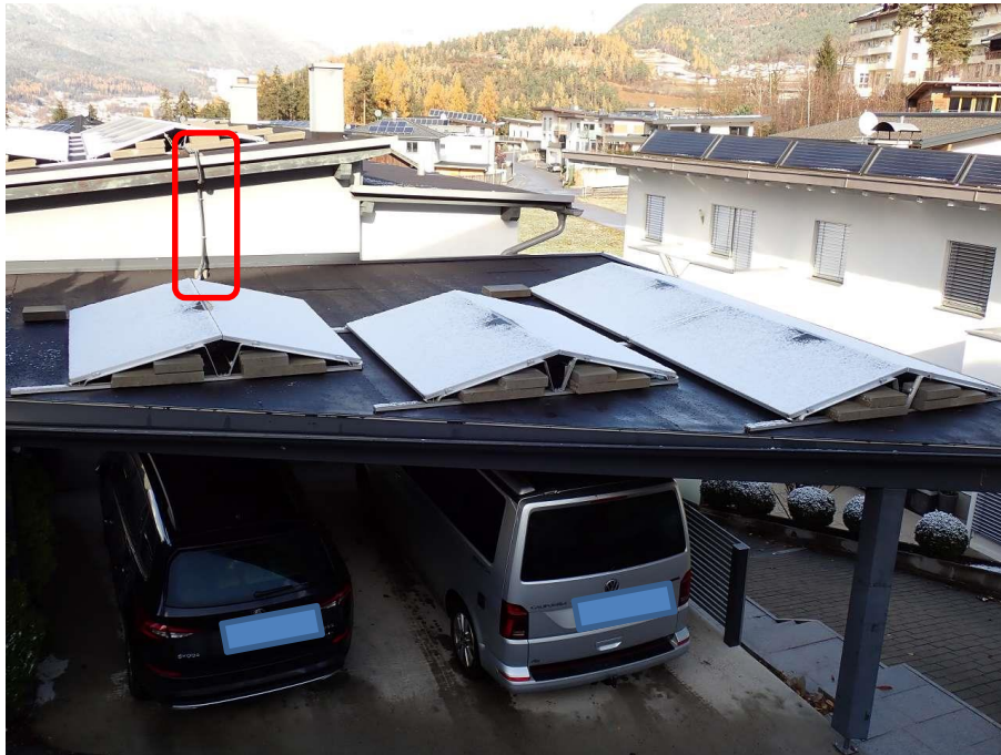
Abbildung 5: Carport mit 8 PV-Modulen + Verkabelung
