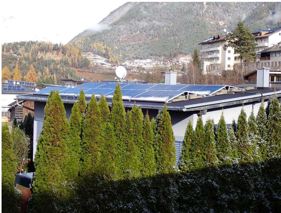
Abbildung 4: Hauptdach mit 20 PV-Modulen
