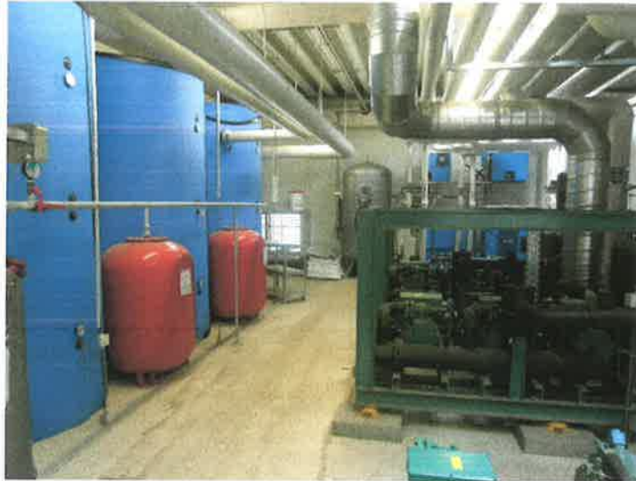
Photo 28: Betriebsgebäude – Obergeschoß – Kühltechnikraum
