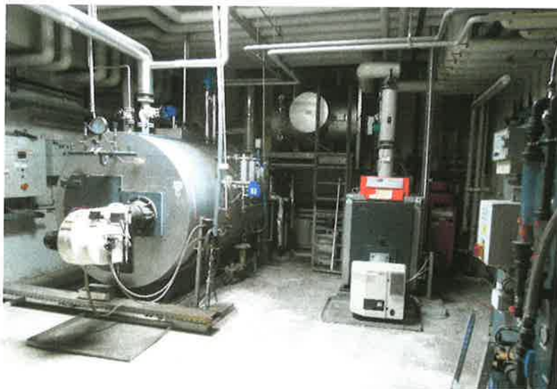
Photo 27: Betriebsgebäude –Obergeschoß – Heizraum (links >Dampfkessel, rechts > Heizkessel
