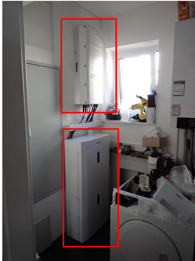
Abbildung 8: Übersichtsbild Wechselrichter + Batterie
