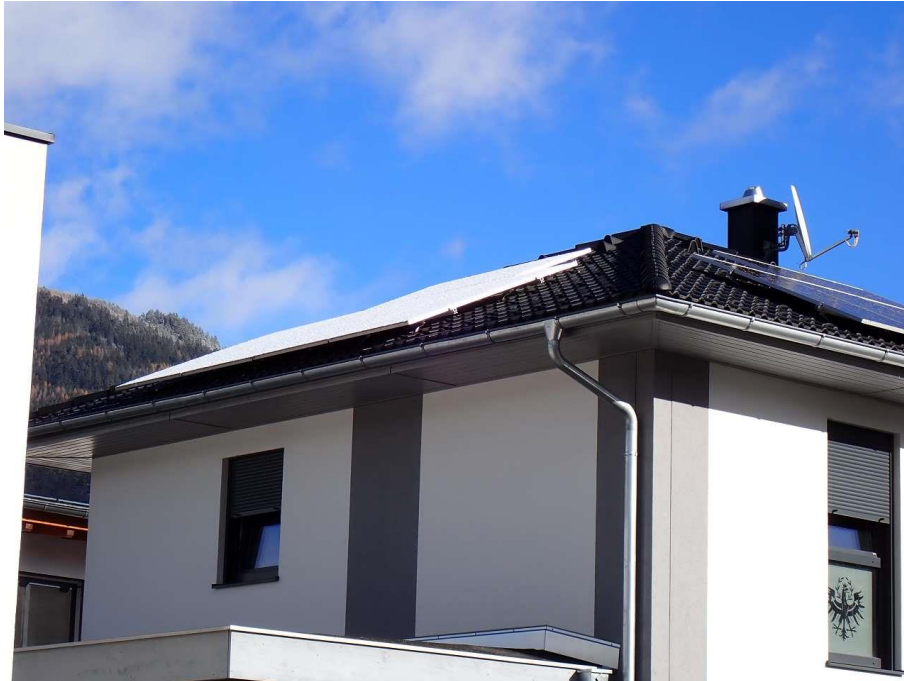
Abbildung 5: Dachfläche West (5 Module)
