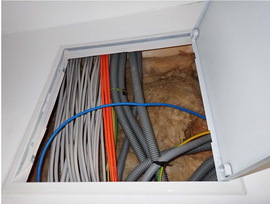
Abbildung 16: geöffneter Steigschacht mit Installationsschläuchen
