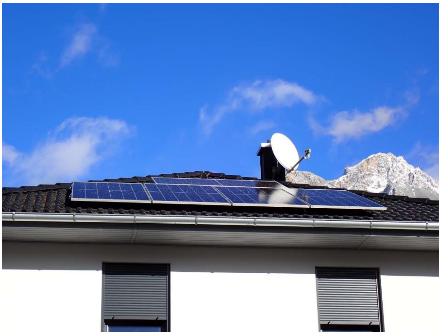
Abbildung 6: Dachfläche Süd (5 Module)
