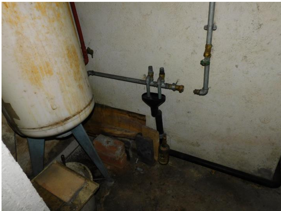
Kellerraum mit Haustechnik
