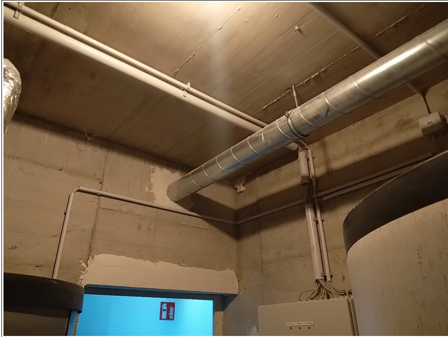
Bild_26: Innelliegender Raum OHNE Zu,- UND Abluft (Leitung durchquert den Raum!)
