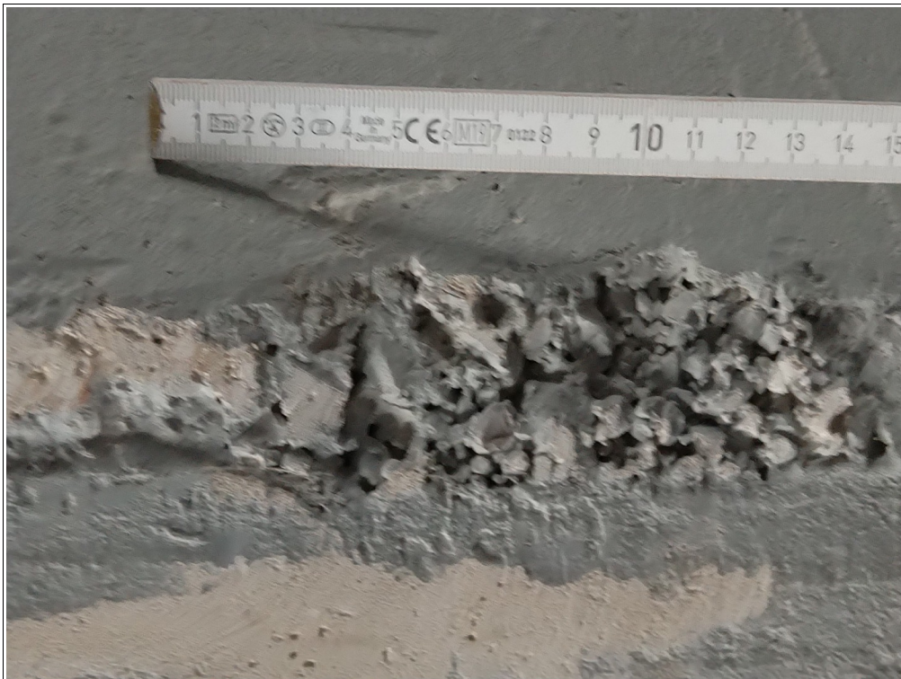
Bild_18: Betonnester Garagenwand
