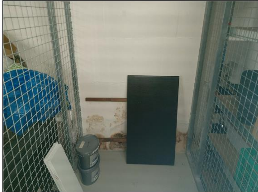
Bild_20: Kellerabteile Schimmelspuren im Sockelbereich
