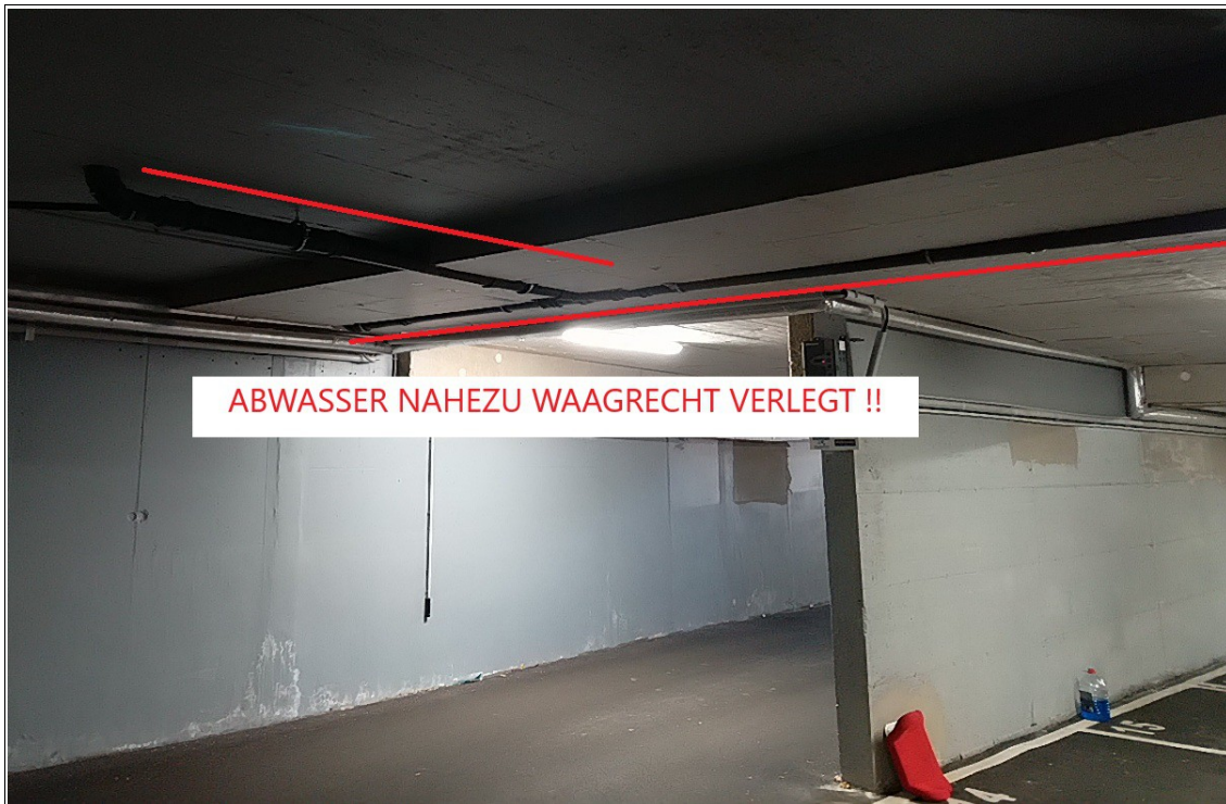
Bild_23: Horizontalleitungen Regenwasserkanal
