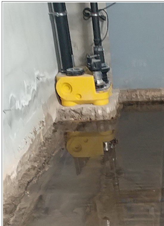
Bild_21: Hebeanlage oberhalb FFOK. Kellerabstellräumen
