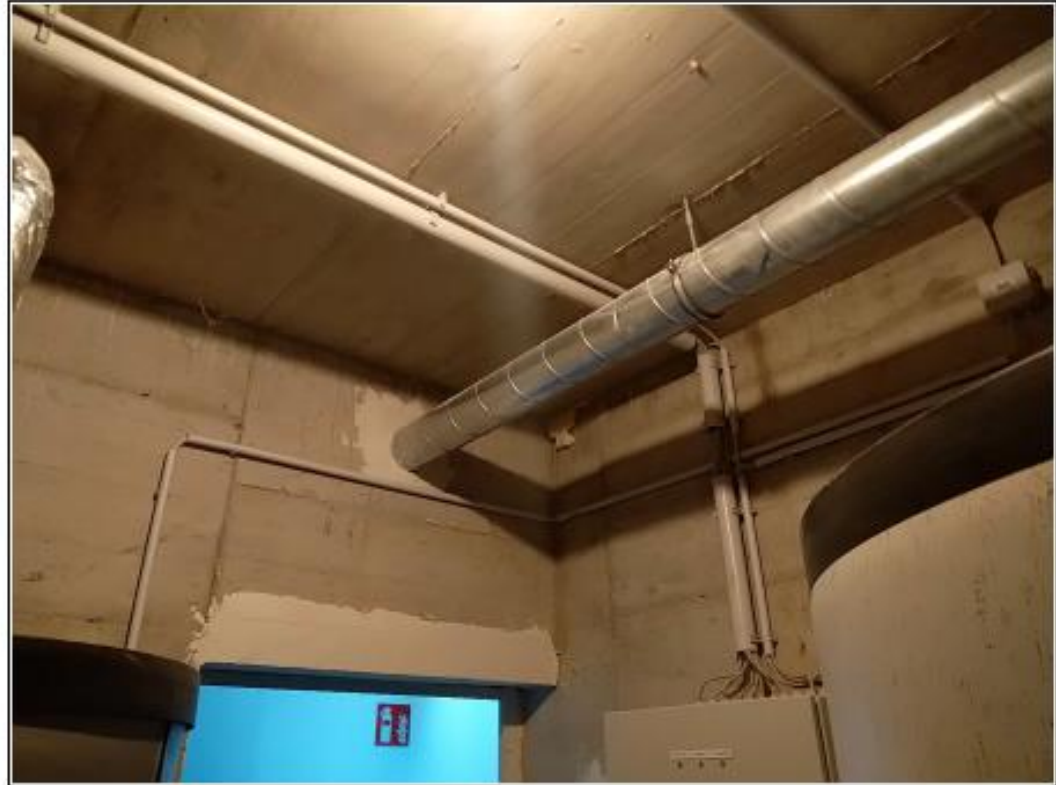
Bild_26: Inneliegender Raum OHNE Zu,- UND Abluft (Leitung durchquert den Raum!)
