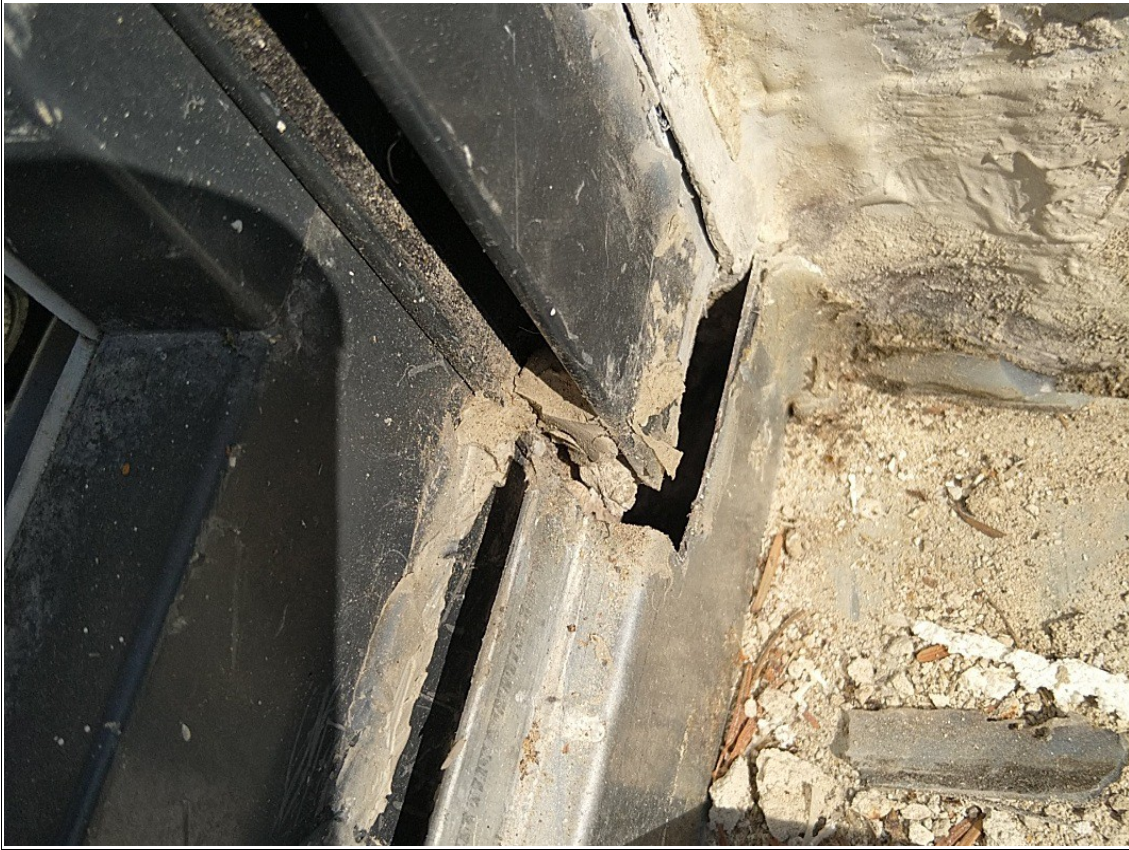
Bild_10: Rigol im Bereich der Rolladenführung ausgeschnitten, Abdichtung mittels Silikonwalzen, zwischen Rigol und Türstock Luftspalt.
