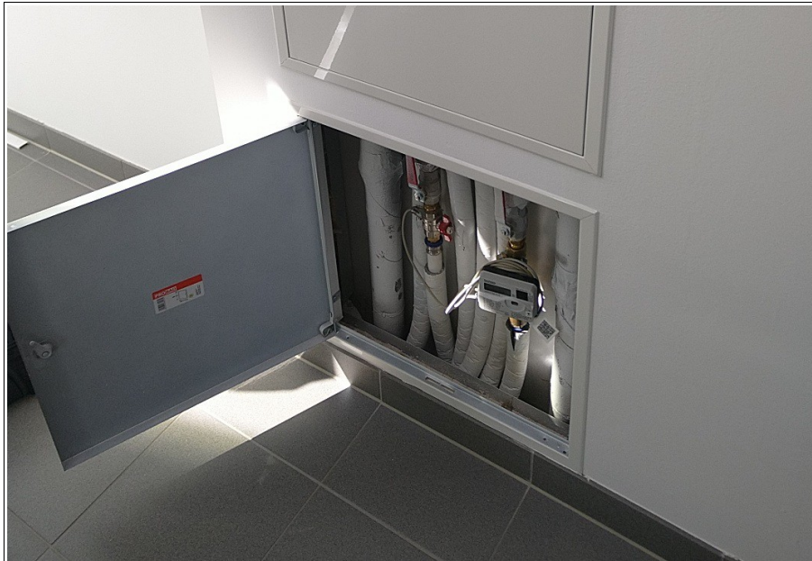
Bild_24: Schacht in Fluchtweg ohne Brandschutz (Stiegenhaus MTG)
