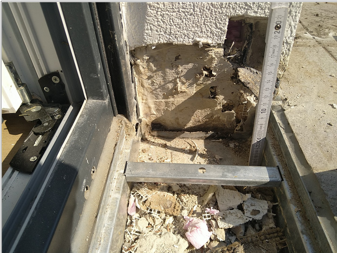
Bild_09: Freigelegtes Rigol | Ablauf nicht angebunden, kein Seitenabschluß
