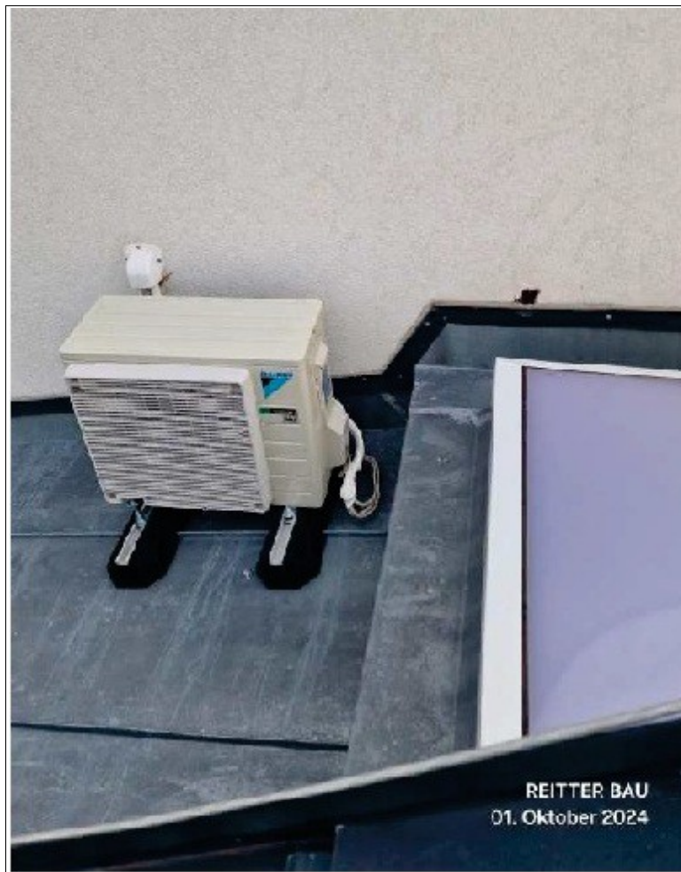
Bild_03: Blechdach oberhalb Stiegenhaus (MTG), Höhen Wandanschluß, Mindestgefälle, Fassadenloch ?
