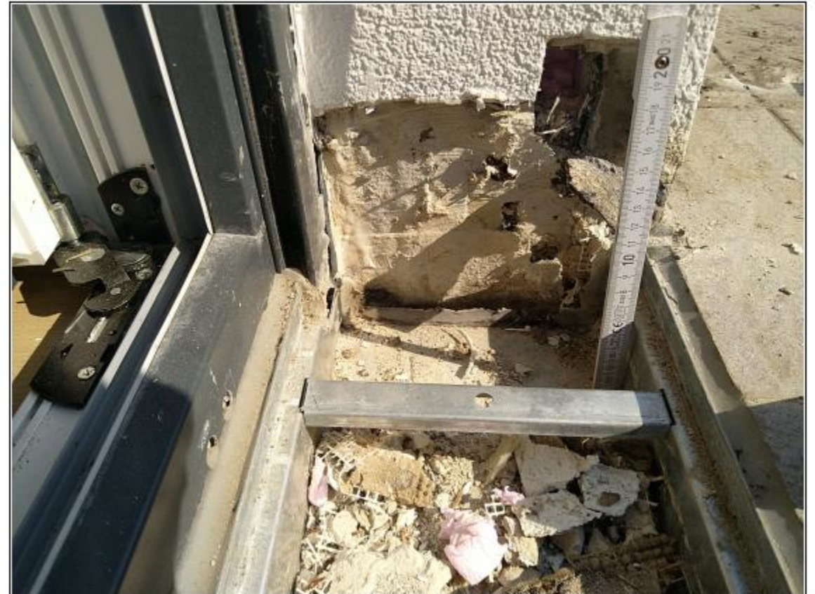
Bild 09: Freigelegtes Rigol | Ablauf nicht angebunden, kein Seitenabschluß
