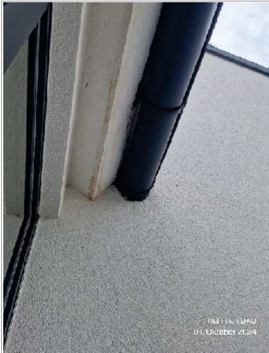
Bild_04: das Unterdach entwässert in das verputzte Gesimse – Hier sind deutliche Wasserspuren sichtbar !!
