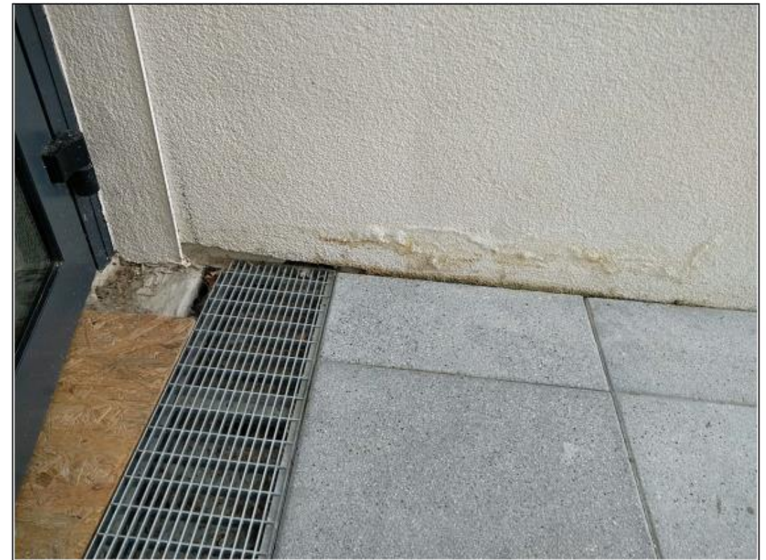
Bild_05: Wasserschaden Sockel Eingangstüre
