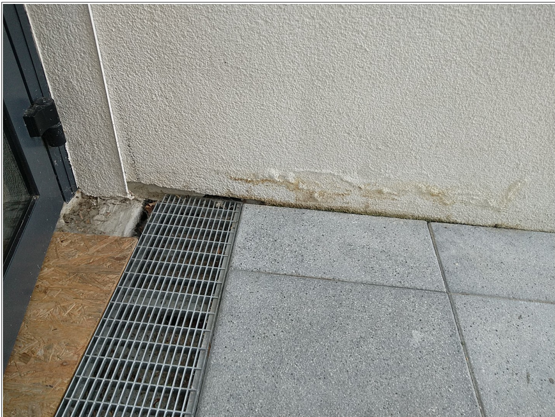
Bild_05: Wasserschaden Sockel Eingangstüre
