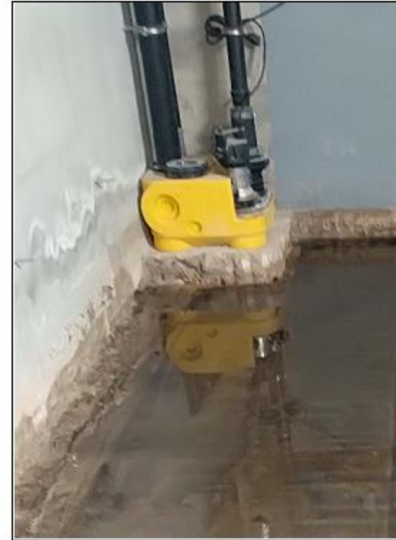
Bild_21: Hebeanlage oberhalb FFOK. Kellerabstellräumen
