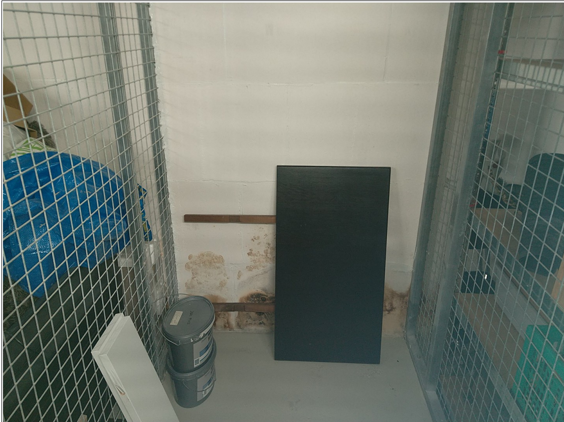
Bild_20: Kellerabteile Schimmelspuren im Sockelbereich
