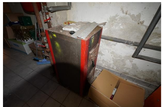
Heizung feste Brennstoffe -außer Betrieb
