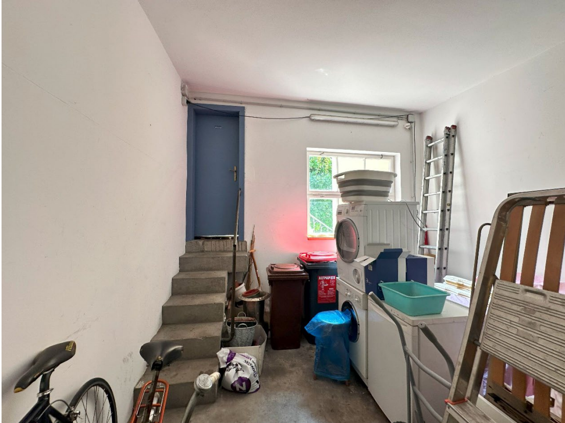
Foto 33: Lagerraum | Feuchtigkeitsspuren im Bereich der Decke
