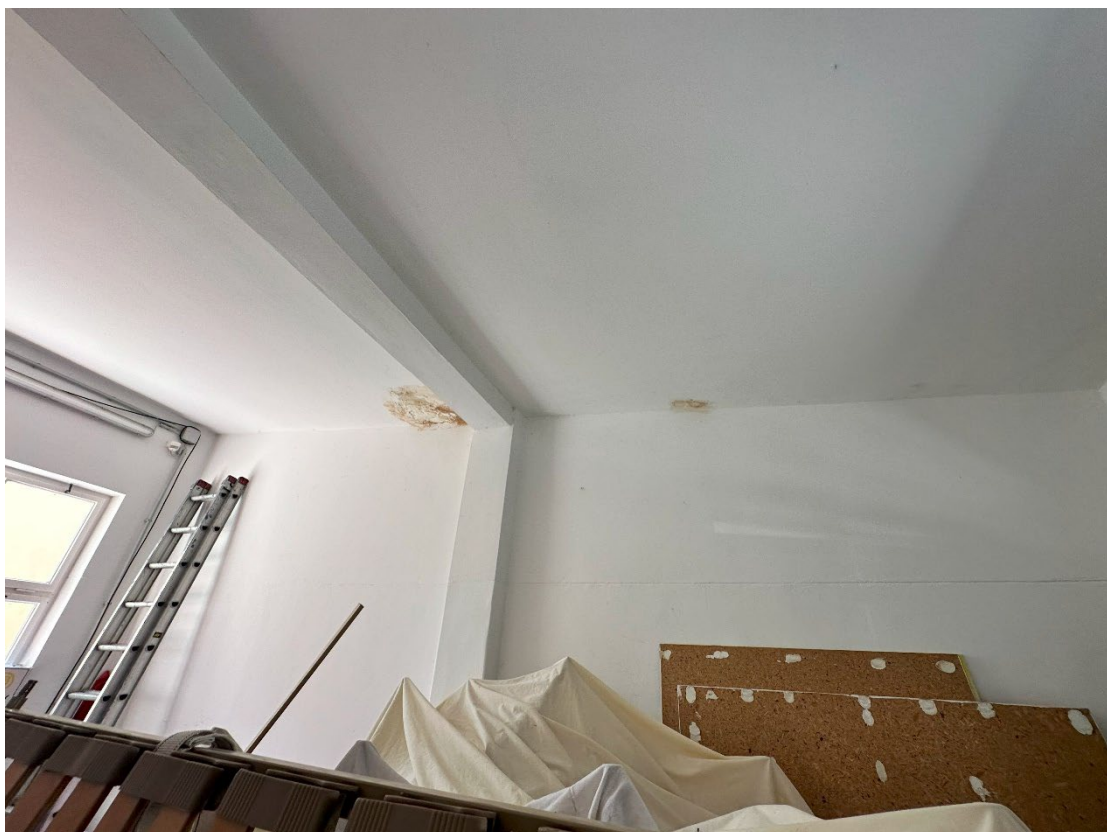
Foto 32: Waschküche / Lagerraum | Feuchtigkeitsspuren im Bereich der Decke | UG
