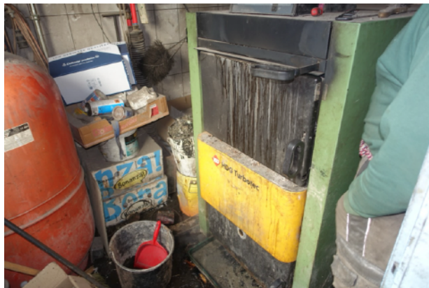
Heizung (im Untergeschoss vom Auszugshaus)
