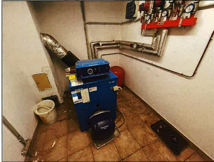
Heizraum (allgemeine Räumlichkeit)
