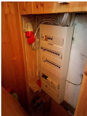
Windfang (Abstr.) mit Verteilerkasten
