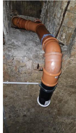
„Kleiner Raum“- Entlüftung unterer Bereich
