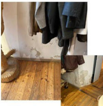
Lederwarengeschäft sind alle Wände feucht
