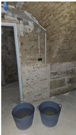
Wasser von Decke
