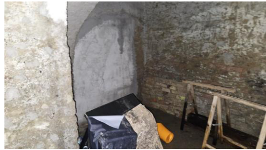
„Großer Raum“- Hinterer Bereich – Nässeintrag – Hier auch der ehemalige Durchgang zum „kleinen Raum“
