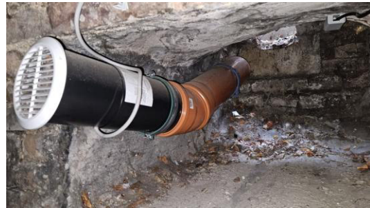
„Kleiner Raum“- Entlüftung Ri Nikolaigasse
