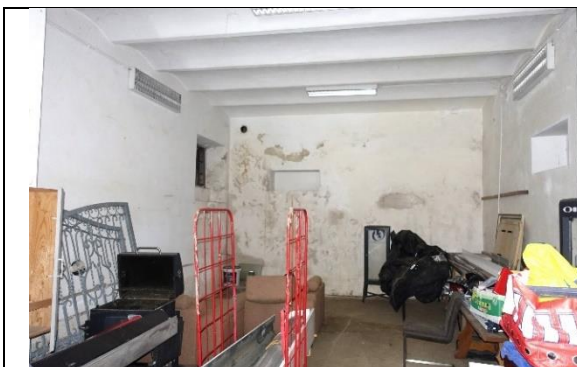
Garage: Boden: Beton; Wände: verputzt und gemalt; Decke Filigrandecke geweißt; erkennbare Feuchtigkeitsschäden im Bereich der Wände;
