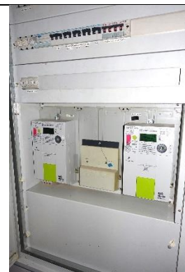
Elektrohauptverteiler und Zählerschrank:
