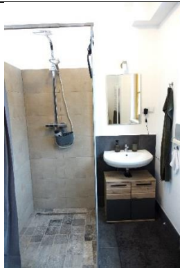
Waschraum/WC: Sanitärausstattung: 1 Waschbecken mit Unterschrank, 1 begehbare Dusche mit Glasduschtrennwand, Armatur und Ablaufrinne; 1 Hänge-WC mit Unterflurspülkasten;
