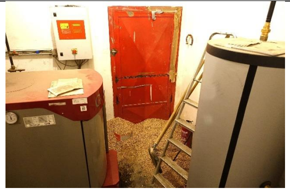
Heizraum: Boden: Beton; Wände und Decke: verputzt und gemalt; 1 Pellets-Heizkessel (Fabr Gilles HPK-RA 30, Nennwärmeleistung 30 kW, BJ 2006), 3 Heizkreise; 1 Warmwasserspeicher (Fassungsvermögen 300 l);
