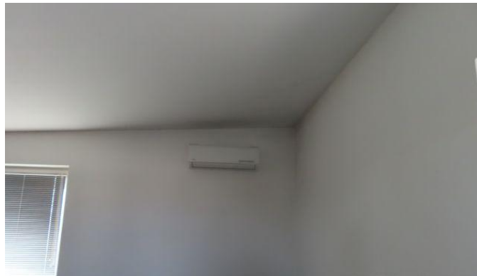
Abb. 36: Klimagerät Büro OG
