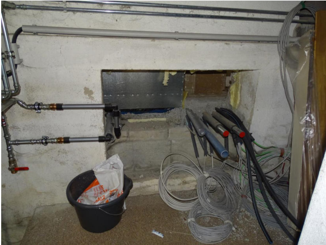
Bild 47 Unfertige Installationen beim KG Stiegenpodest zum angebauten Nordtrakt
