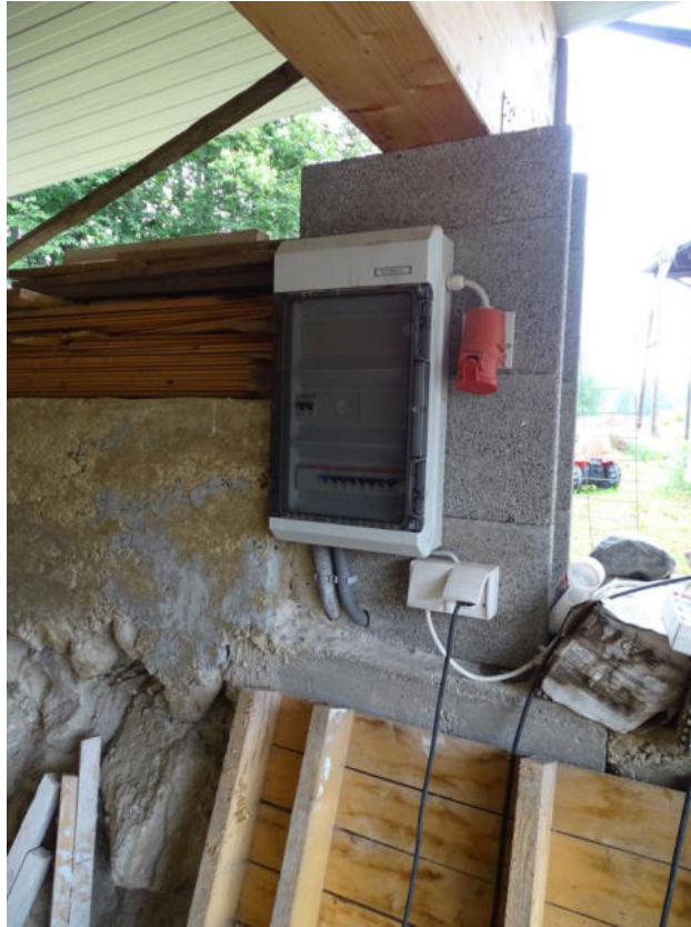
Bild 51 KFZ-Unterstellplatz mit Subverteileranlage
