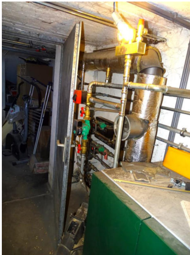
Bild 46 KG Heizraum mit Rauchrohranschluss und Warmwasserverteilung
