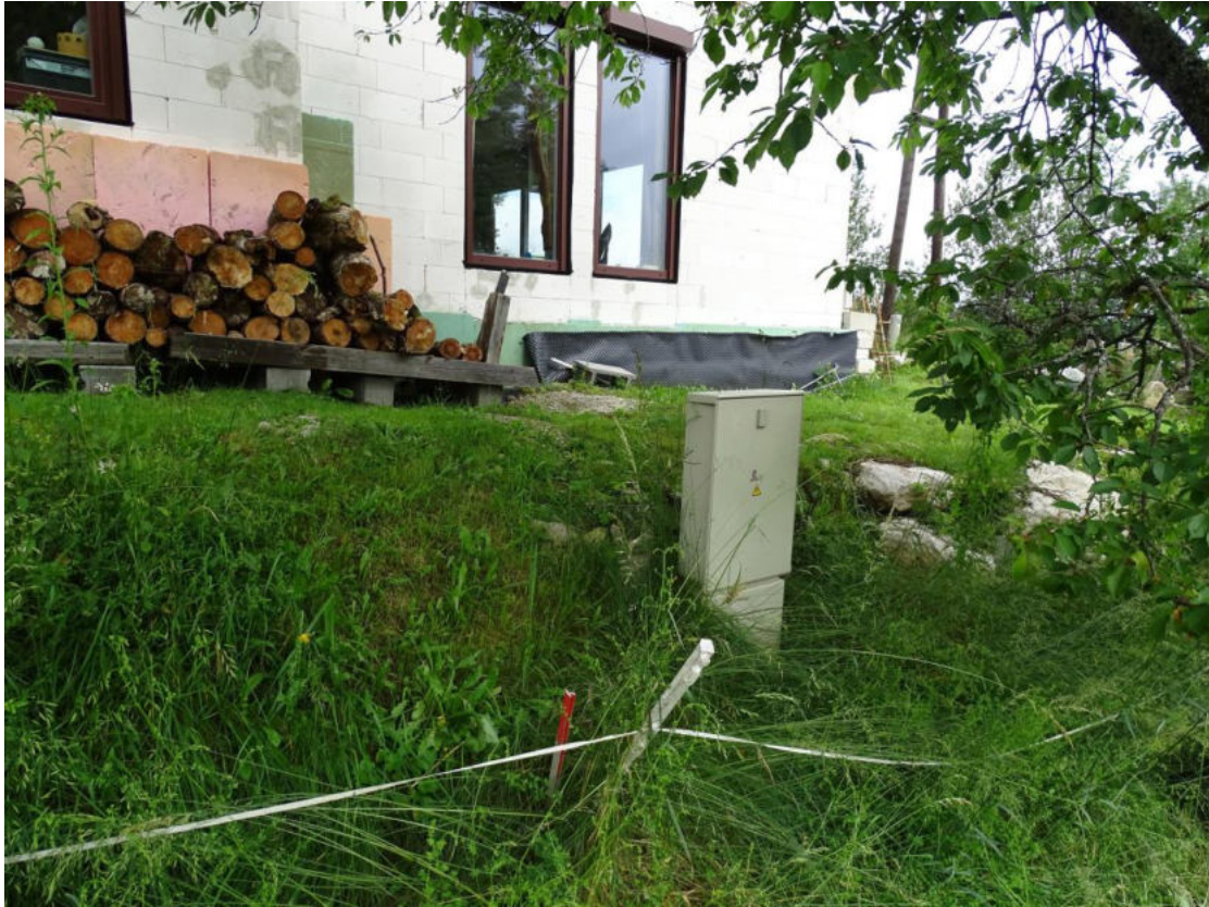
Bild 63 E-Verteiler-Erdkabelanschluss an der Ostseite zur Straße
