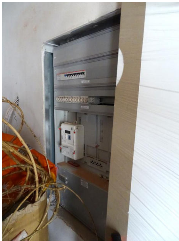
Bild 48 E-Verteiler beim Zubau Nord
