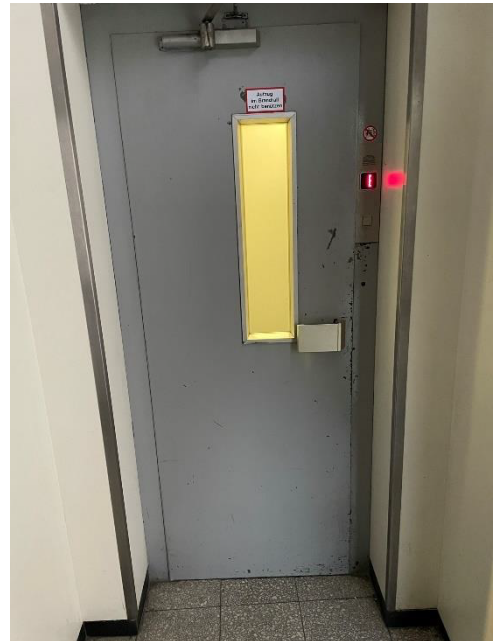
Bild 6 von 16 Blick auf die Personenliftanlage
