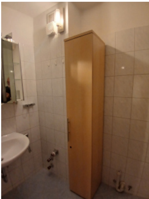
Wasserzähler und Waschmaschinenanschluss
