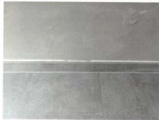
Zeigt den Schadensbereich am Mauerwerk im Schwimmbad
