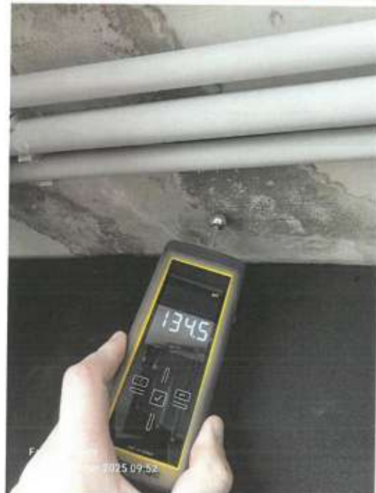
Zeigt den erhöhten Feuchtigkeitsmesswert an der Decke im Technikraum
