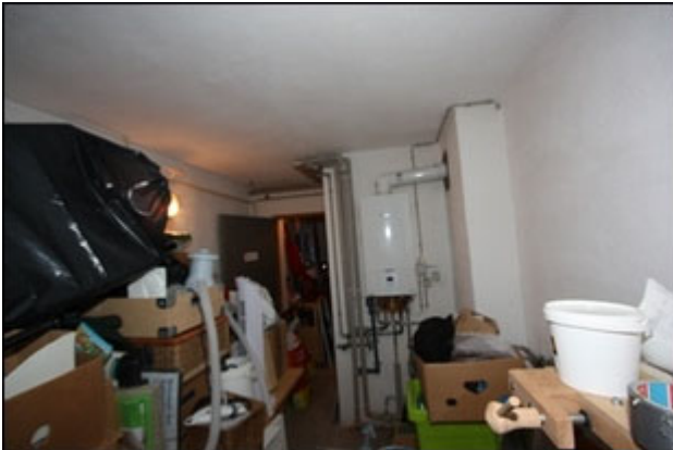
Abb.45 Ansicht Kellerraum (Heizraum), Gastherme
