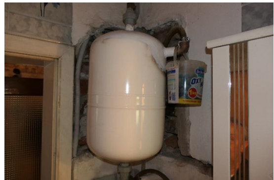
Expansionsgefäß Heizung (im Bad)
