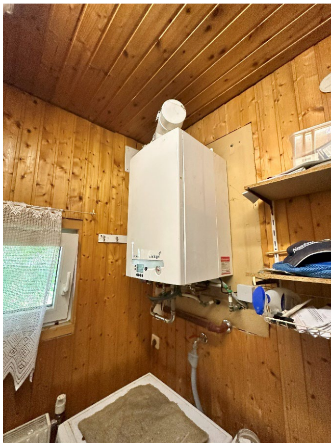
Foto 17: Abstellraum mit Gastherme
