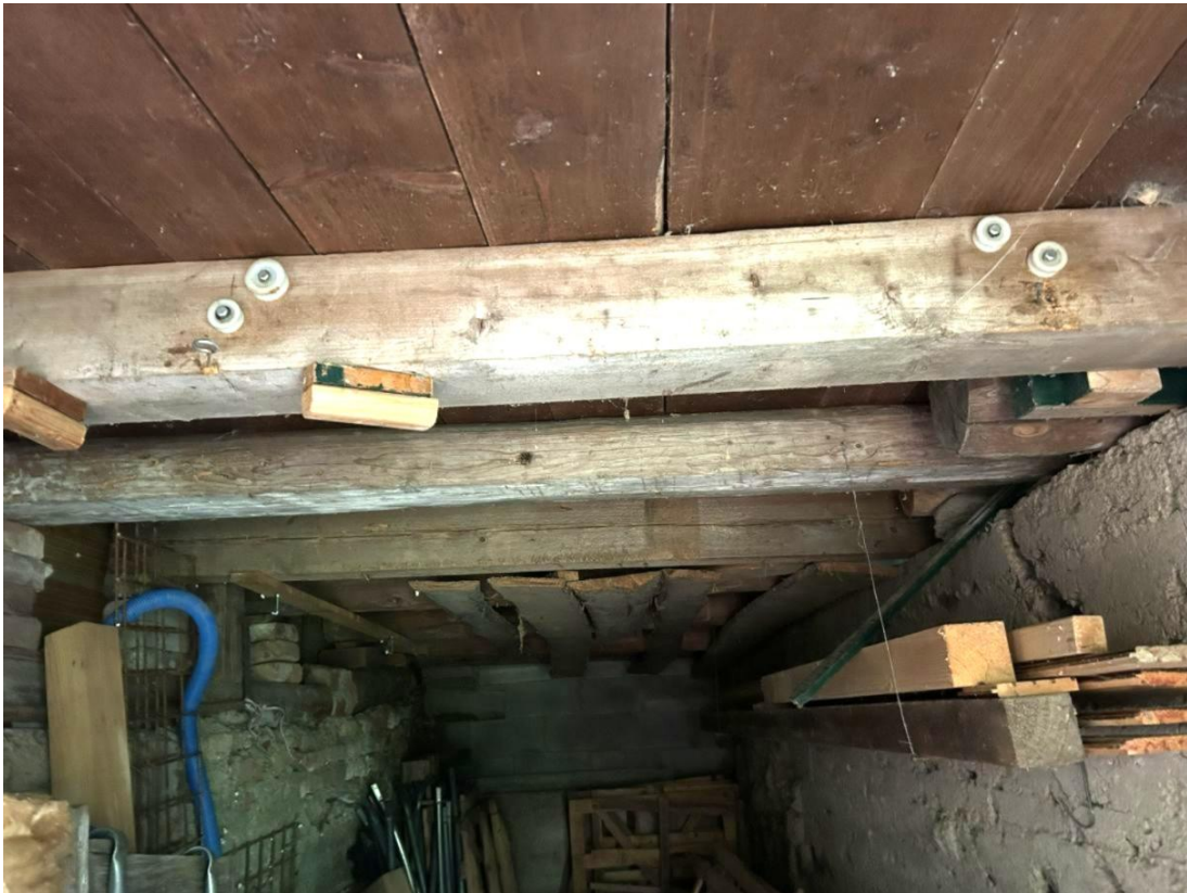
Bild 11: Tramlage der Kellerdecke (schadhaft)
