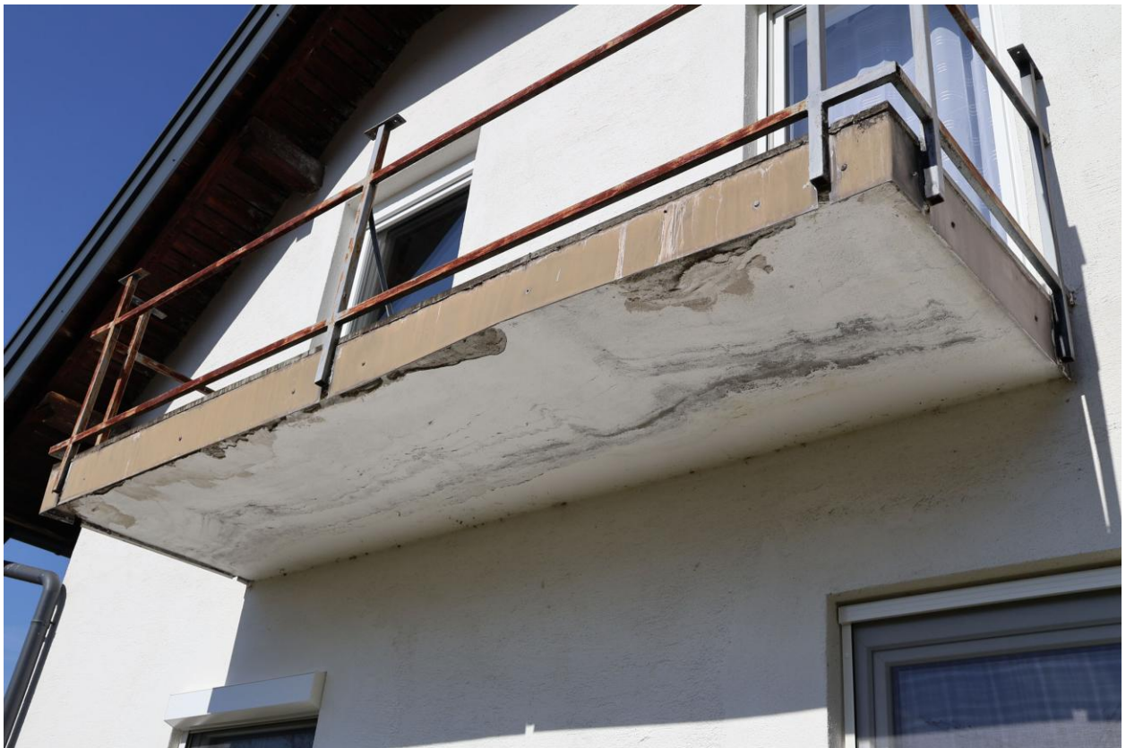
Bild 6 Balkon Ostseite mit Feuchteschäden an der Untersicht
