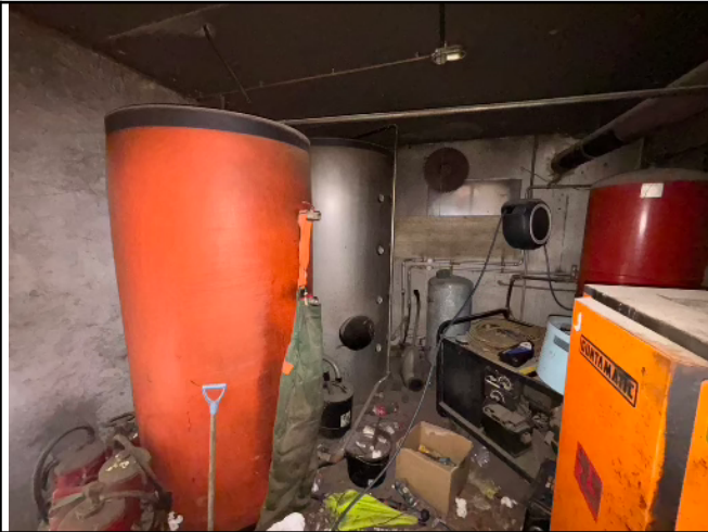
Heizraum im KG der Abstellhalle. Heizkessel Guntamatic ca. 30 Jahre alt Boiler und Pufferspeicher
