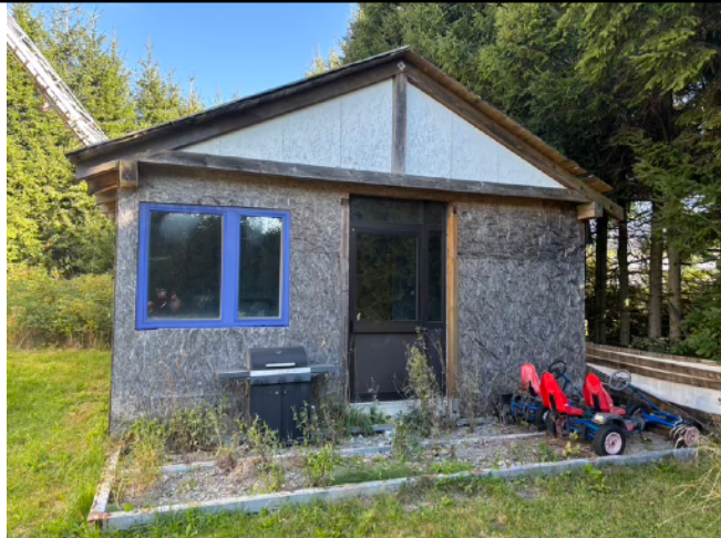
Illegal errichtetes Gartenhaus im rückwärtigen Teil als Container ausgeführt. Aus OSB Platten gefertigt Kunststofffenster. Dach provisorisch mit Bitumenpappe eingerollt. Lückig und defekt.
