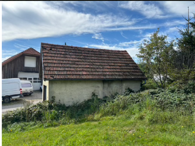
Nordansicht mit Schadhafter Dachhaut. Der rechte Gebäudeteil dürfte auf Fremdgrund stehen.
