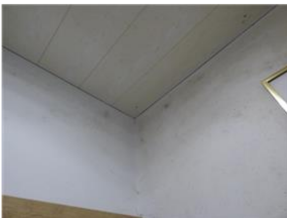
Bad Schimmelbefall an Decke und Wänden
