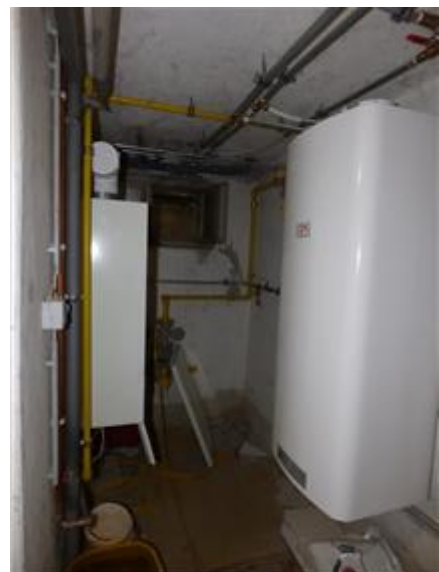
Vorkeller mit Gastherme und Warmwasserspeicher
