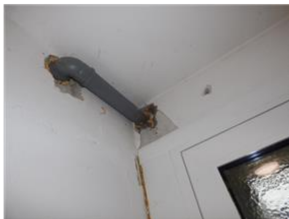
Kunststoffrohr zur Garage
