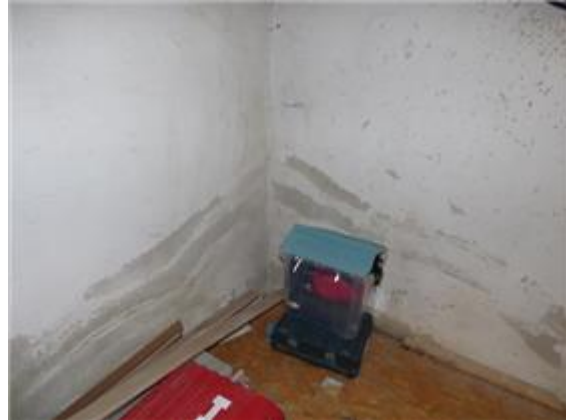
Feuchteintritt mit Putzabblätterungen
