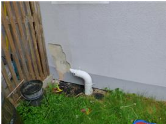
Feuchteschaden Außenmauer neben Geräteschuppen
