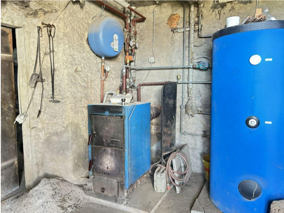
Bild 5: Zentralheizungskessel Buderus mit WW-Boiler
