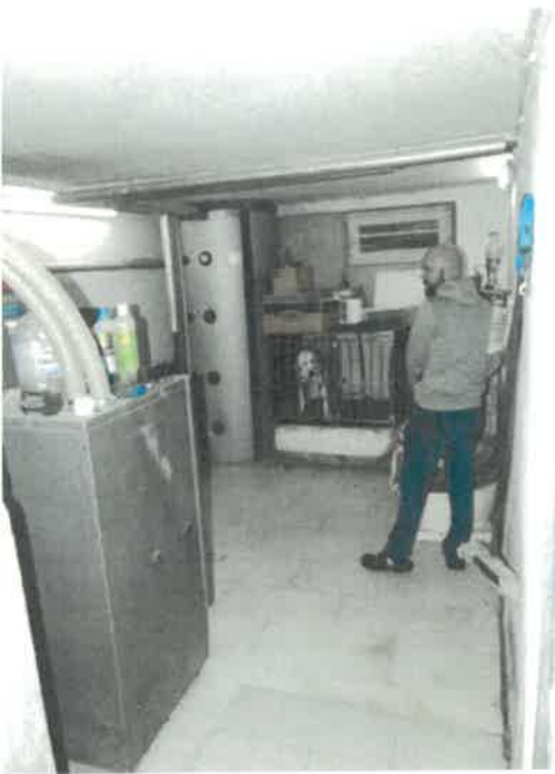
Lagerraum mit Öltank
