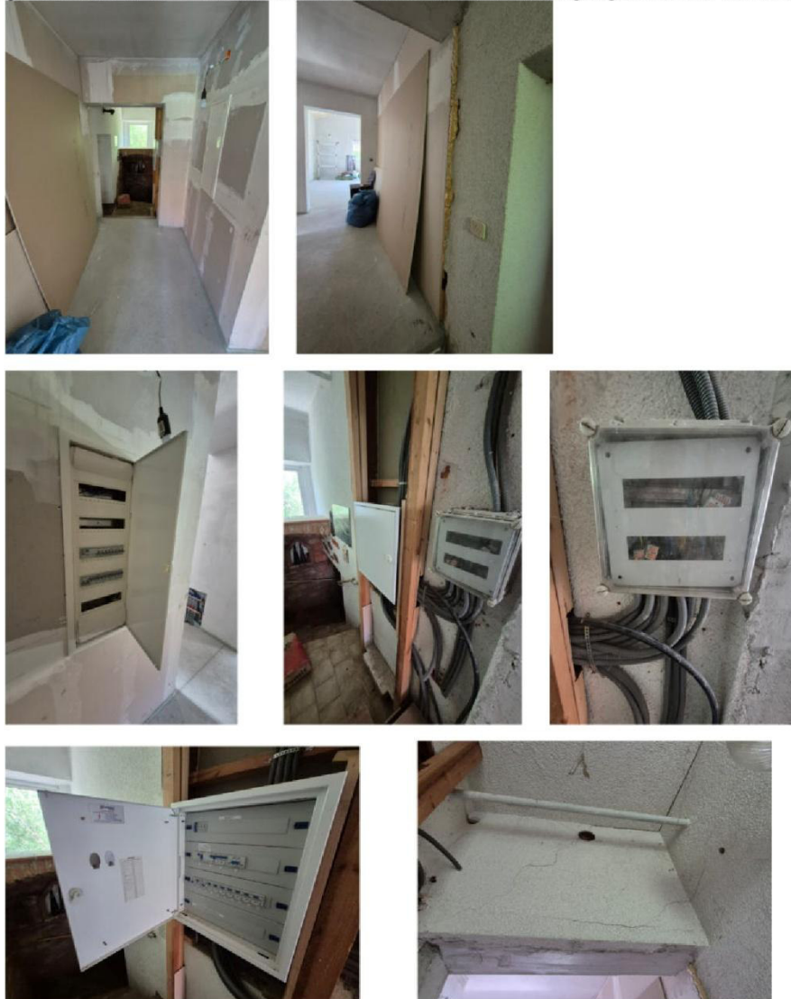
Gangbereich mit diversen Schaltschränken und Sturzbereich und Abgangsbereich in den Keller
