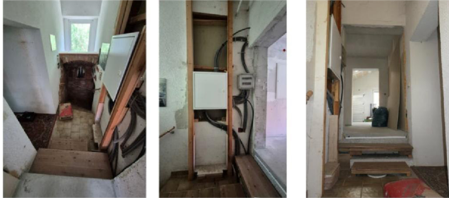
Fußbodenabschluss mit vorgelegten provisorischen Stufen (entspricht nicht dem Einreichplan)
