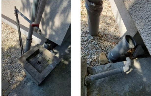
Unfertiger Anschluss zwischen Regenrinne und Abfallrohr
