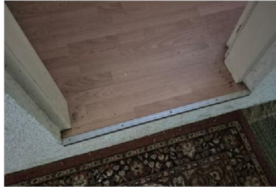
Deutlicher Niveauunterschied (20cm) zwischen den Fußbodenebenen
