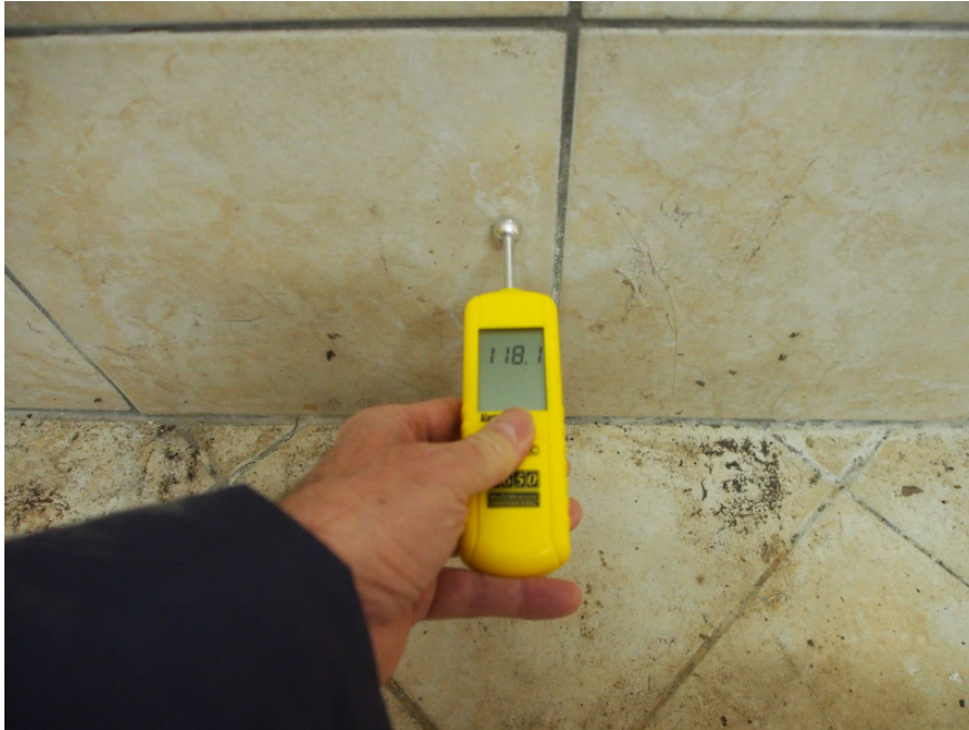
Foto 33 Feuchtemessung Keller Vorraum
