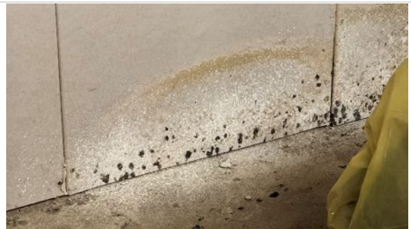
Starke Durchfeuchtungsschäden im Mauerbereich der nicht verputzten Vorsatzschale
