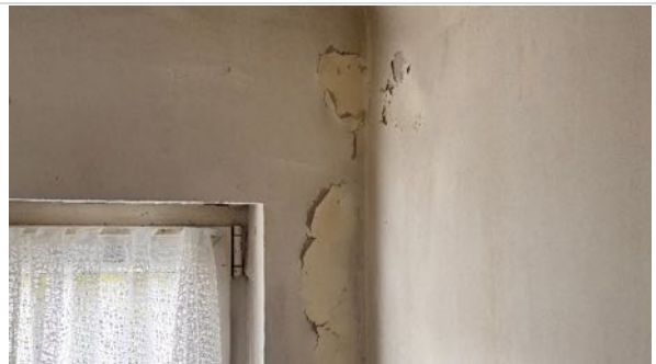
Feuchteschäden im Wandbereich WC
