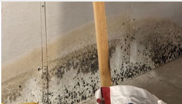
Starke Durchfeuchtungsschäden im Mauerbereich der nicht verputzten Vorsatzschale
