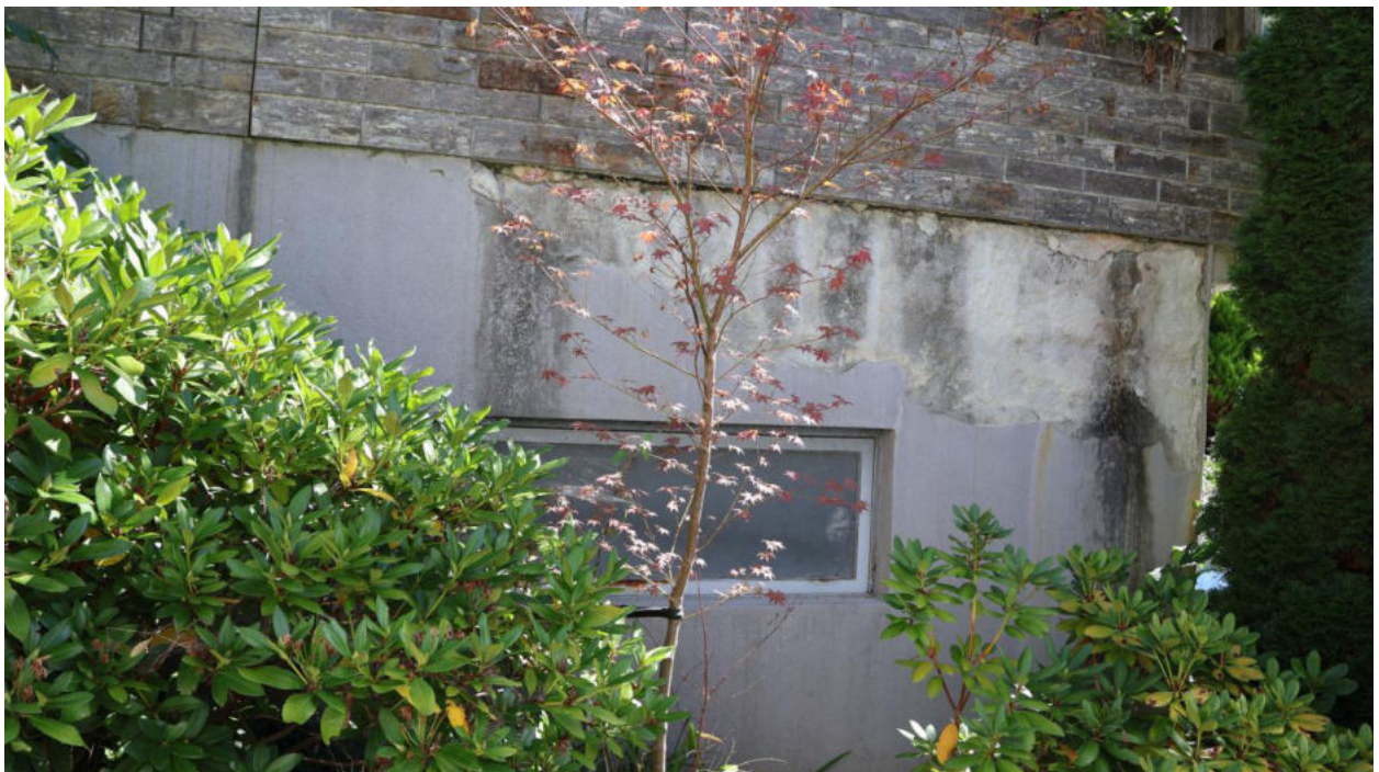
Garagenaußenwand Westseite mit Feuchteschäden im Flachdachbereich der Deckenabdichtung
