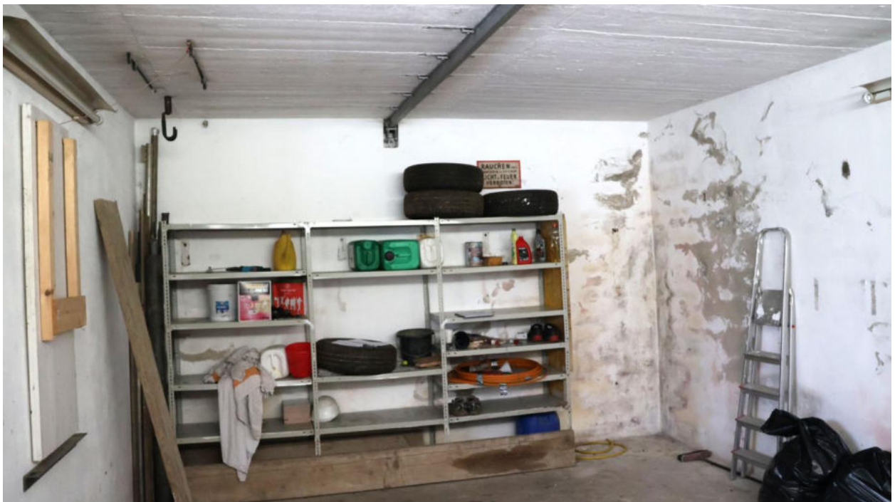
Garageninnenansicht mit starker Wanddurchfeuchtung an der Nordostseite
