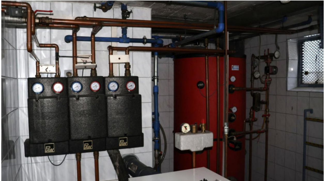
Heizungsverteileranlage mit Pufferspeicher
