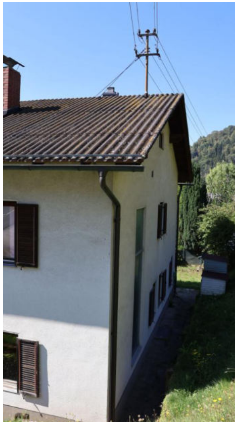
Stromfreileitung mit Dachständer an der Nordseite vom Wohnhaus
