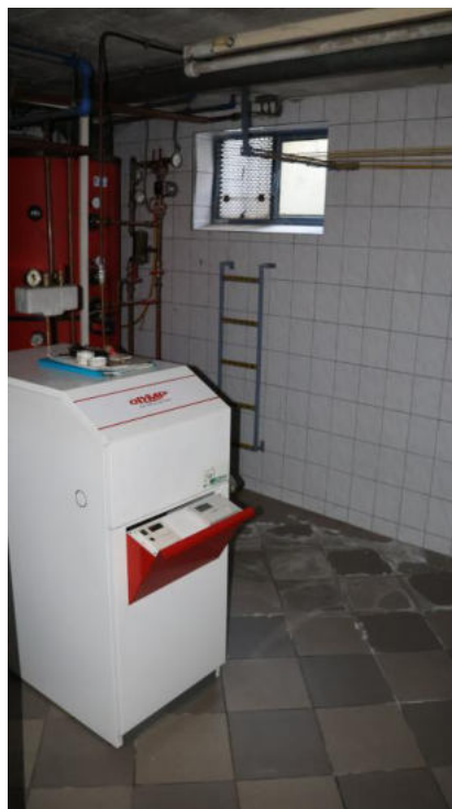
Heizraum mit Ölkessel
