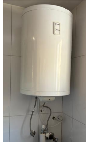
Abbildung 53: Boiler im Badezimmer
