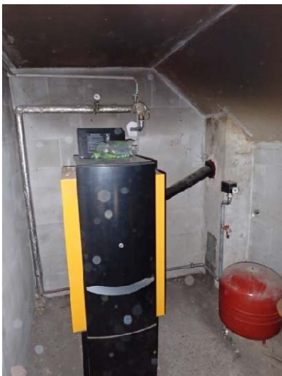
Eingebauter Heizraum mit Pelletsheizung
