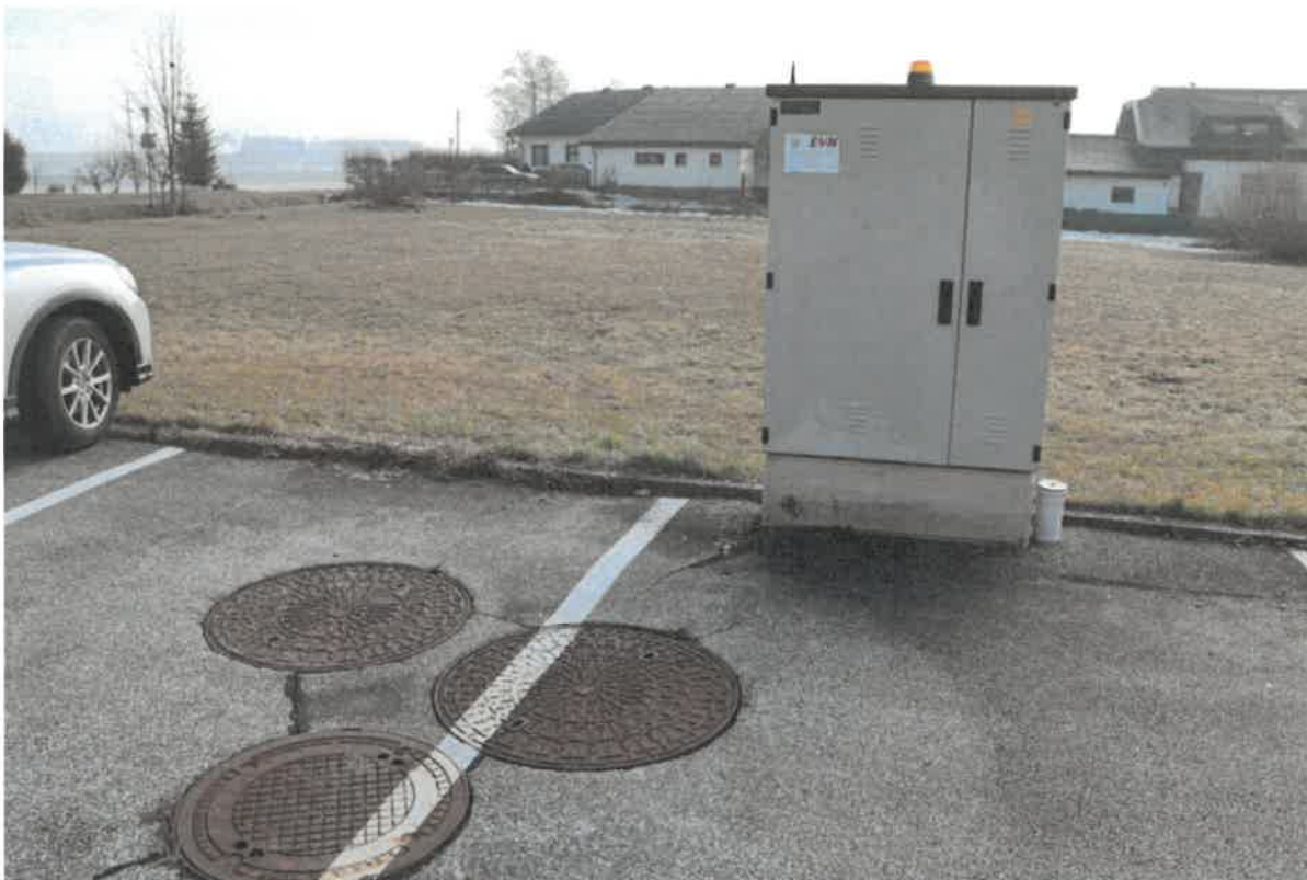
Bild 13 Kanalpumpstation mit E-Verteileranlage
