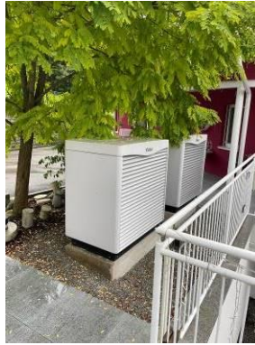
Lüftungsanlagen der WPH
