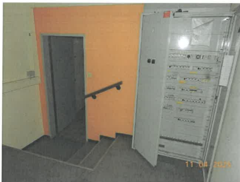
Vorraum vor Heizraum
