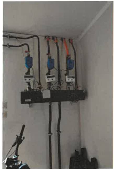
Wohnung W5 / Heizregister
