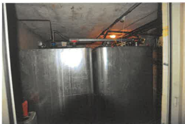
Heizkeller / Neubau / Öl-Tank
