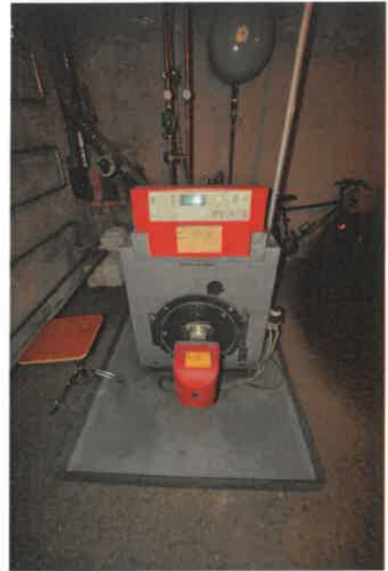
Heizkeller / Neubau / Öl-Zentralheizung
