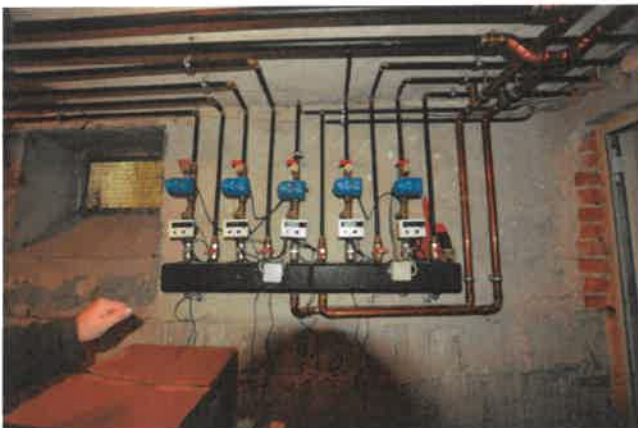
Heizkeller / Neubau / Wasserregister / Wärmehzähler
