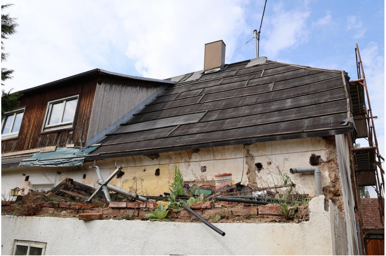
Abgebrochene Dachkonstruktion vom Zubau mit beschädigter Notdachabdeckung vom Haupthaus
