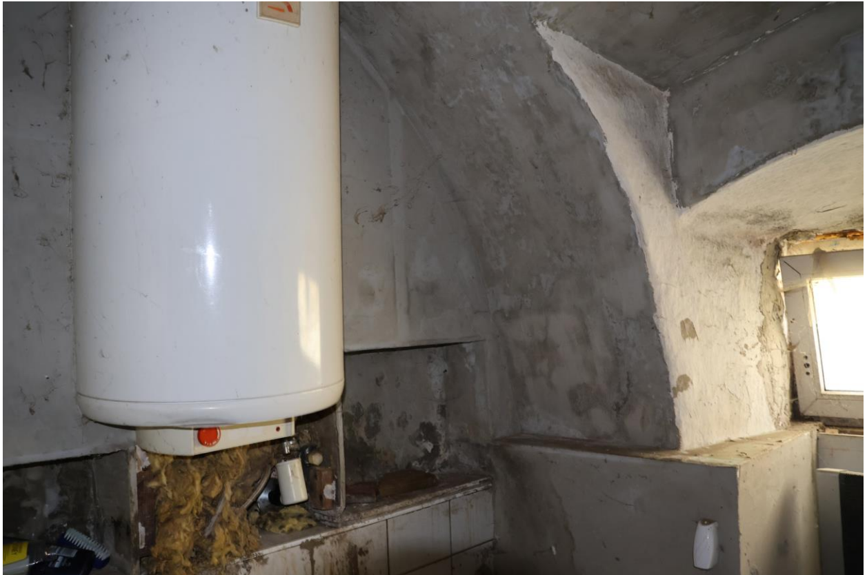
Durchnässte und verschimmelte Gewölbekonstruktion im Badezimmer
