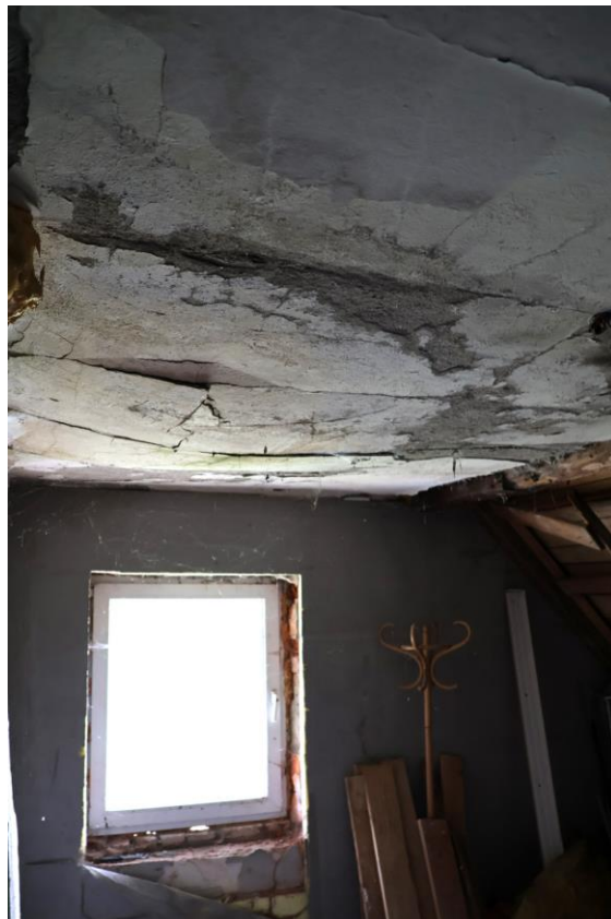
Dachgaube mit bereits abbrechender Untersicht
