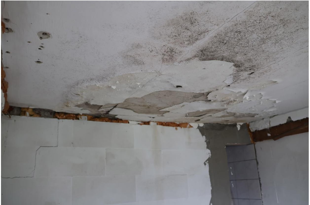
Durchnässte und verschimmelte Dachuntersicht im Dachgeschoss
