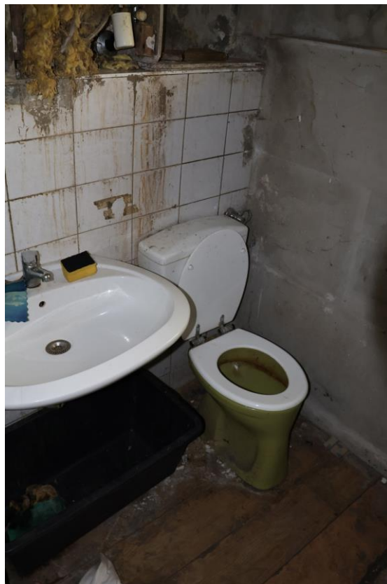
WC mit eklatanten Hygienemängeln
