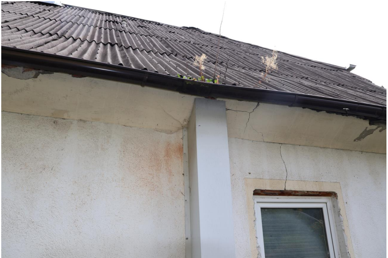
Dachfläche Westseite mit Traufenausbildung und schwerwiegenden Mauerwerksrissen
