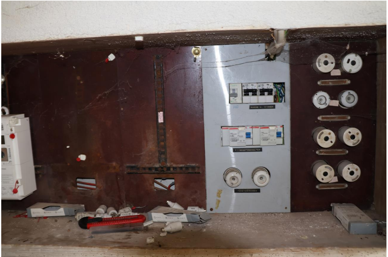
E-Verteiler im Erdgeschoss
