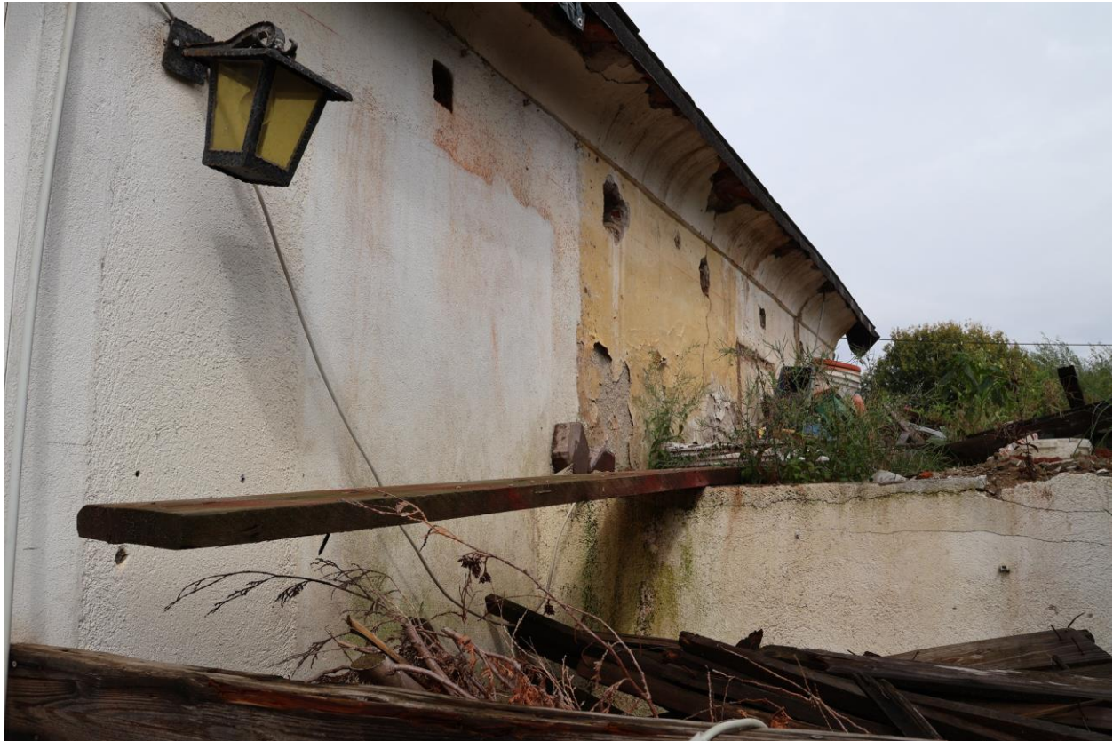
Außenwandbeschädigungen Ostfassade mit Anbautrakt
