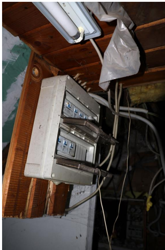
Provisorisch angebrachter Subverteiler im Dachgeschoss
