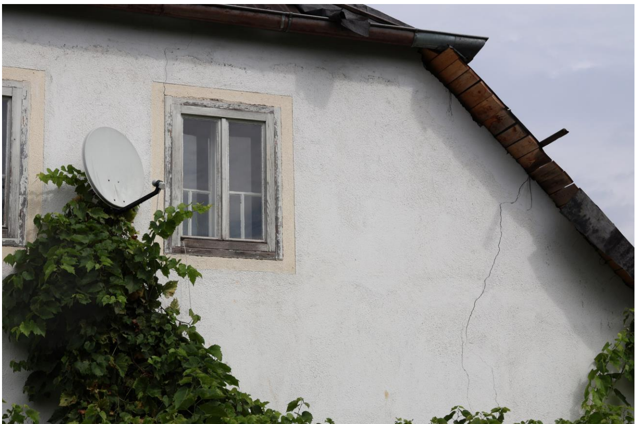
Südseitige Giebelwand mit Mauerwerksrissen und Beschädigungen des Ortgangs
