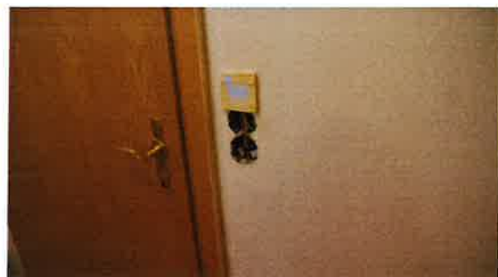
Türe mit rückgestautem Instandhaltungsaufwand
