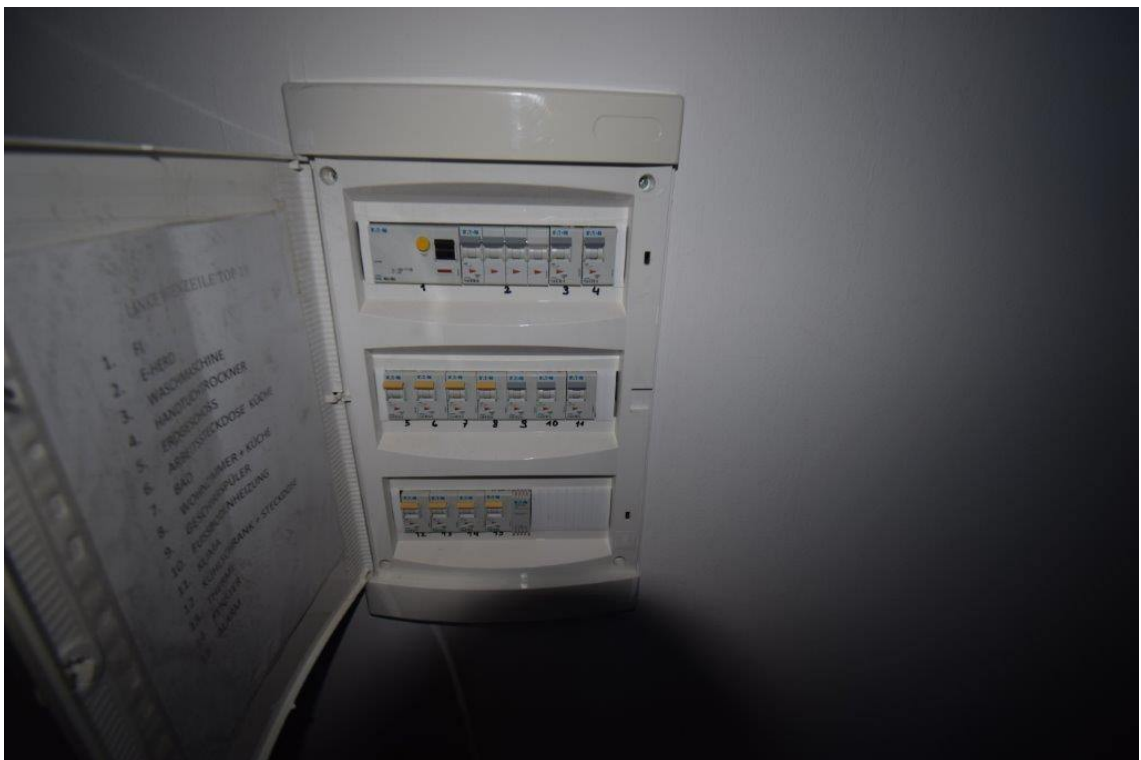
W 19/Vorraum/FI-Schutzschalter 1. Dachgeschoß
