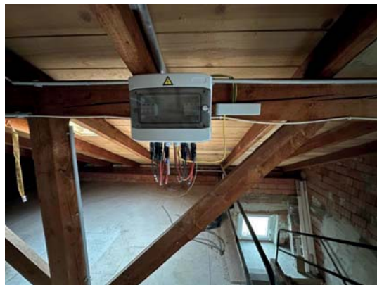
Bild 80- Dachboden Anschlusskasten PV-Anlage
