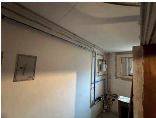
Bild 33 – Kellerraum mit Gas- u. Wasserzähler.
