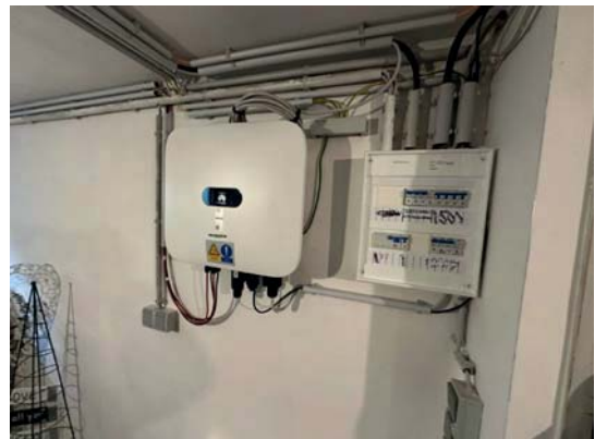
Bild 40 – Wechselrichter für die PV-Anlage
