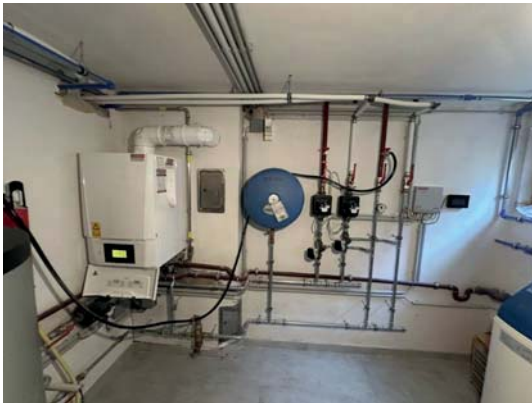
Bild 37 – Heizraum; links Gastherme
