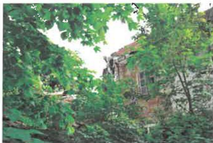
Wohnhaus Brunn 23 / teilweise eingestürzt
