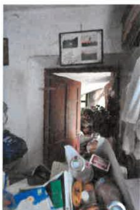
Wohnhaus / Stube / vermüllt
