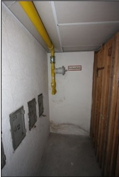
Abb.39 Ansicht KG, Flur/Kellerabteile, Gasleitung
