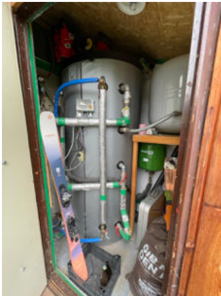
EG Solarspeicher .jpeg
