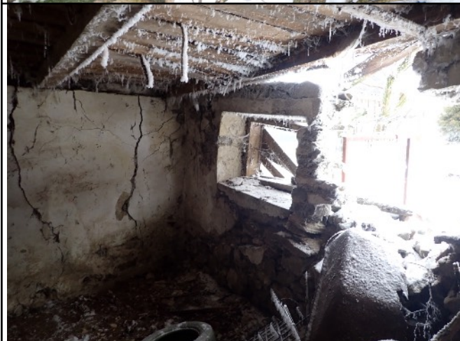
Ehemaliger Stall einsturzgefährdet
