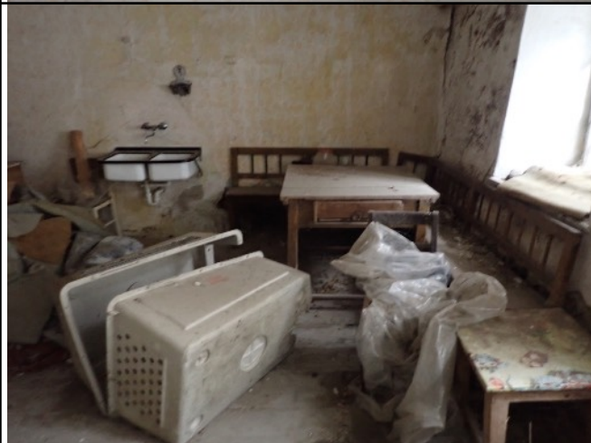
Wand- Deckenriss vermorschter Fußboden.
