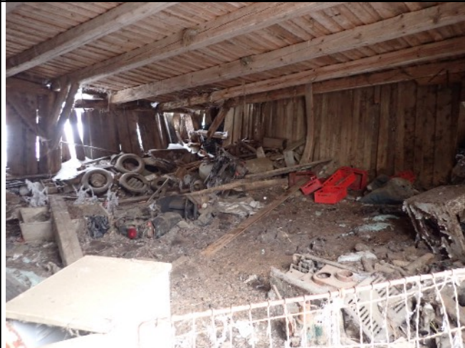
Vermüllter Stadl an der Nordostseite bereits eingestürzt.
