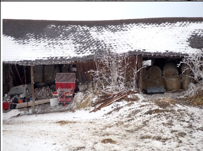
Stadl von der Ostseite im rechten Bildrand Strohlager im Linken Einstellraum vermüllt.
