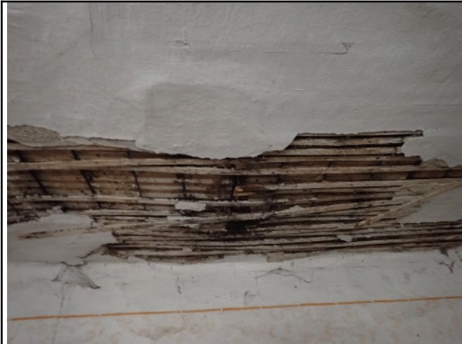
Abgemorschte Decke in der Küche
