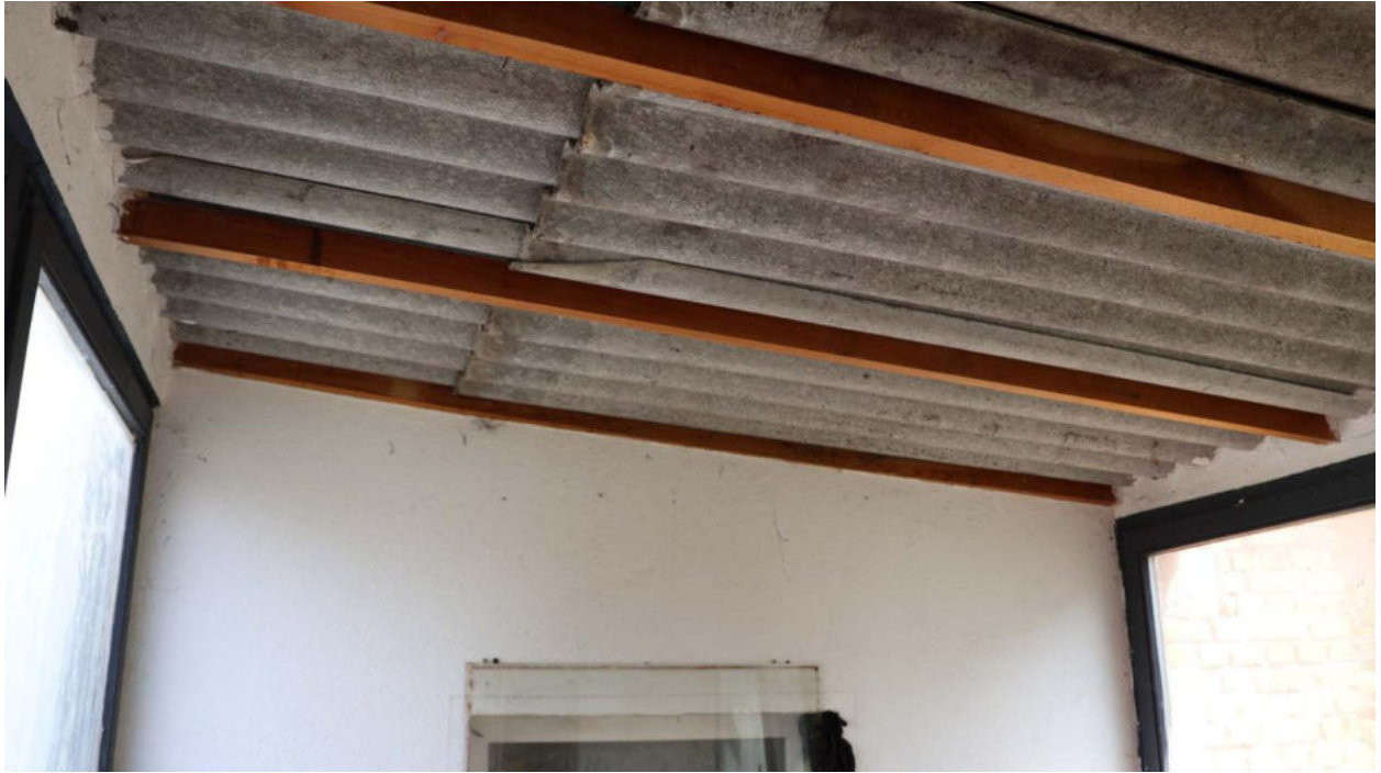
Bild 71 Nebengebäude B - Deckenuntersicht Zwischentrakt
