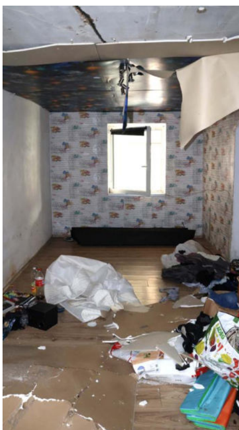
Bild 32 Beschädigtes EG Zimmer Nordost
