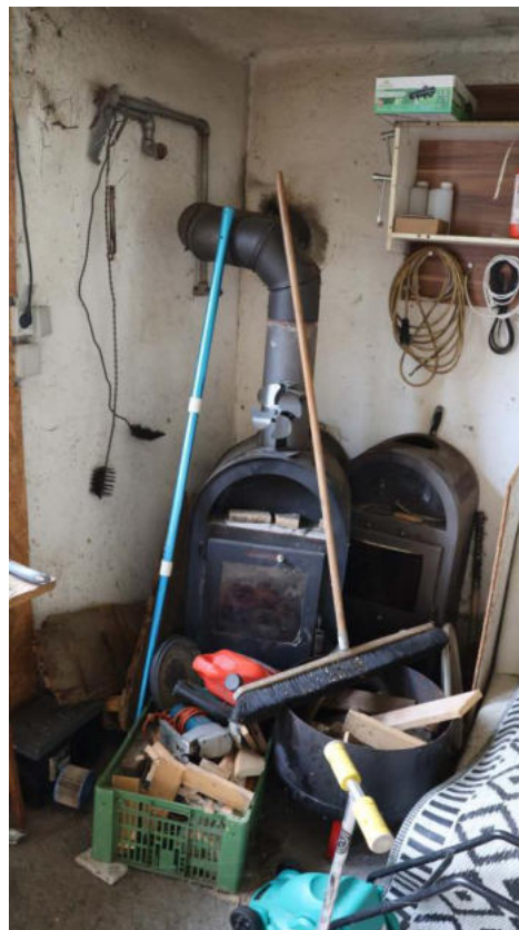
Bild 68 Einzelofen Zimmer Nebengebäude A
