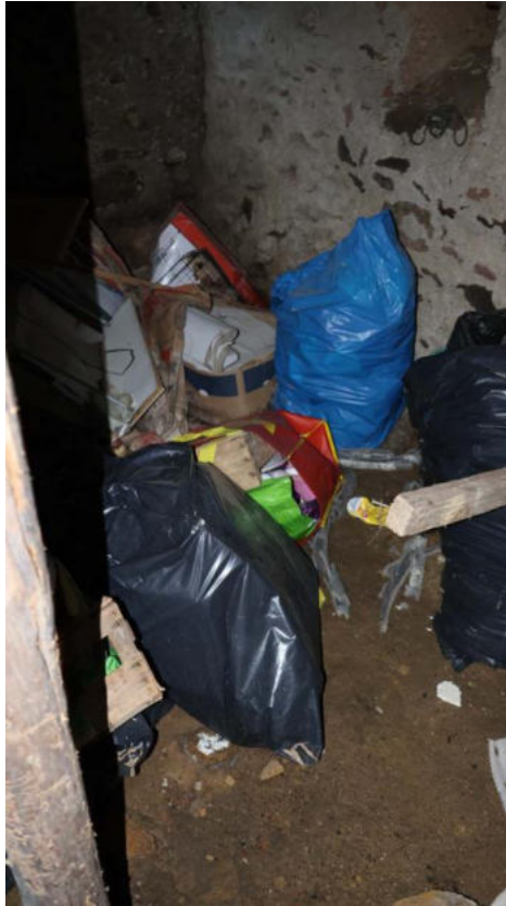
Bild 57 Müllablagerungen im Keller
