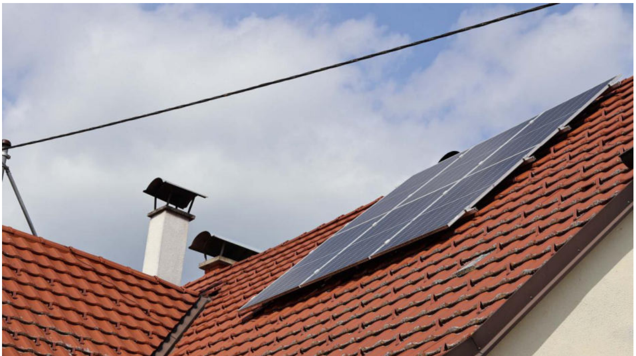
Bild 62 2. Photovoltaikanlage am östlichen Teil vom Wohnhausdach
