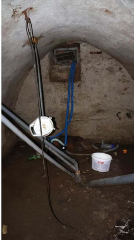
Bild 59 Keller mit Abflussleitungen im Erdboden
