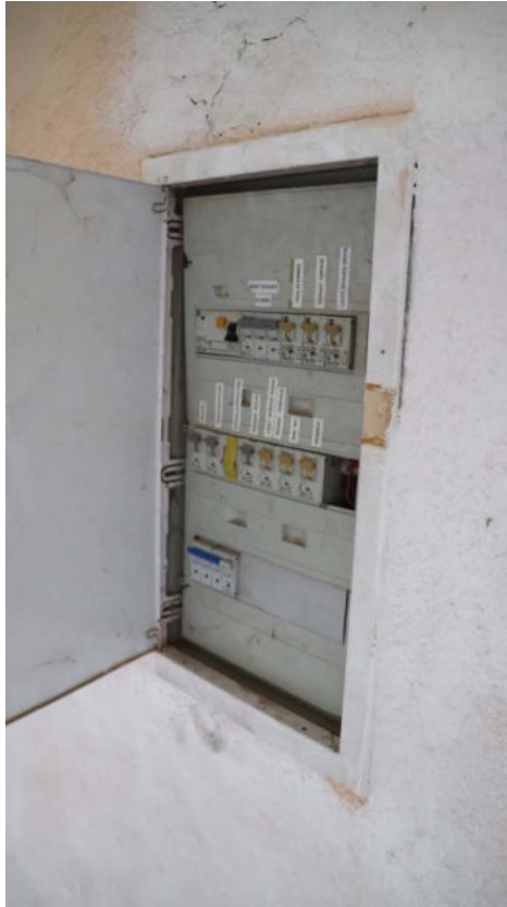
Bild 51 E-Verteiler im DG Flur
