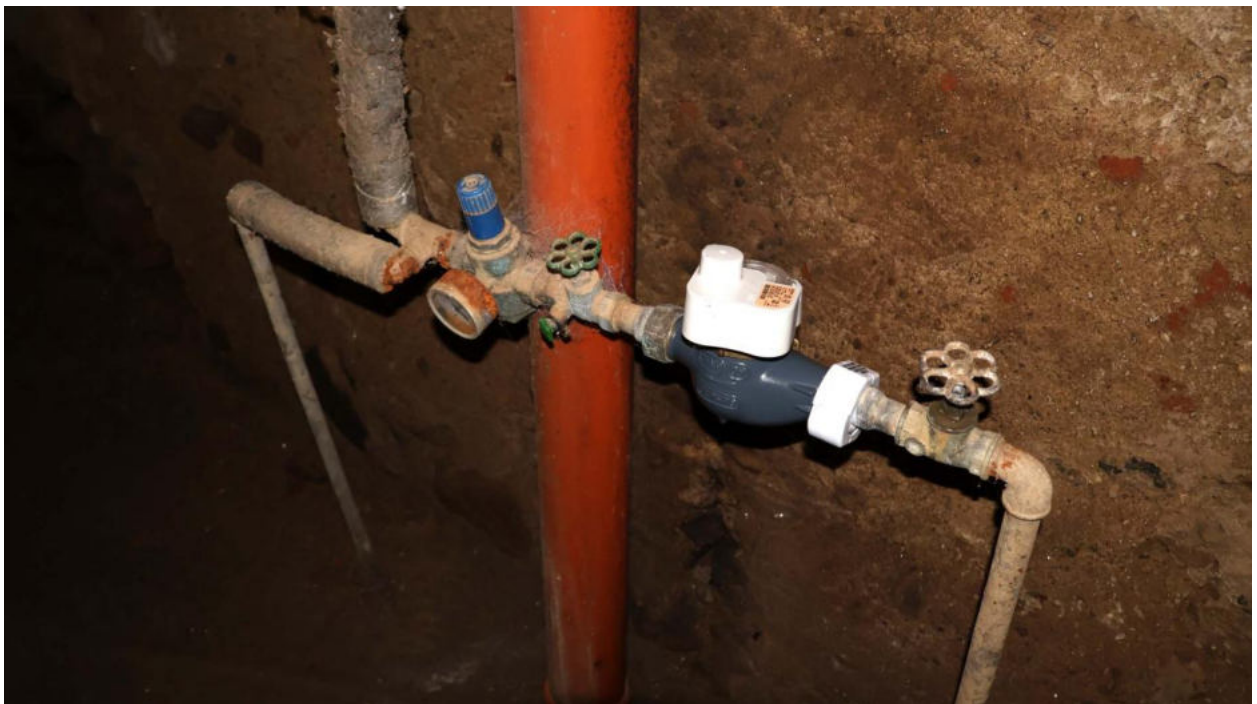
Bild 54 Wasserleitungen Keller mit Wasseruhr
