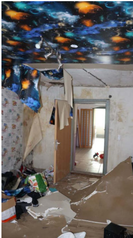
Bild 34 EG Zimmer Nord mit beschädigten Gipskartonplatten
