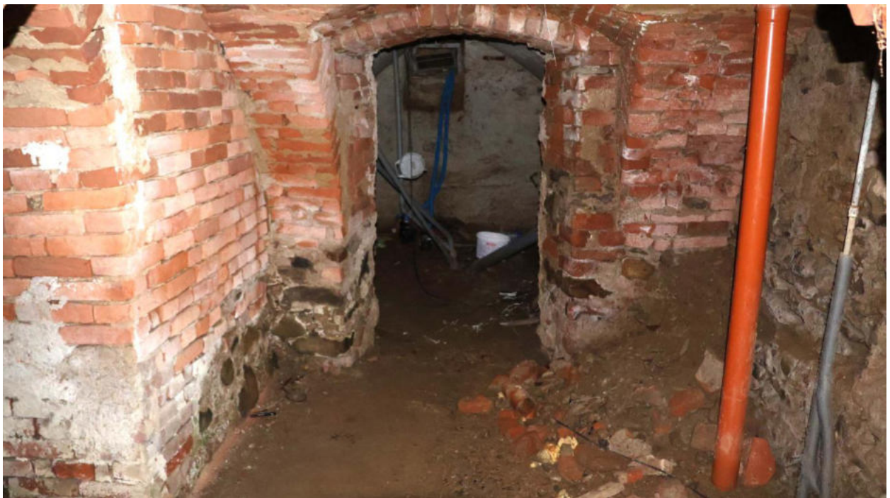
Bild 58 Keller mit durchfeuchtetem Erdboden
