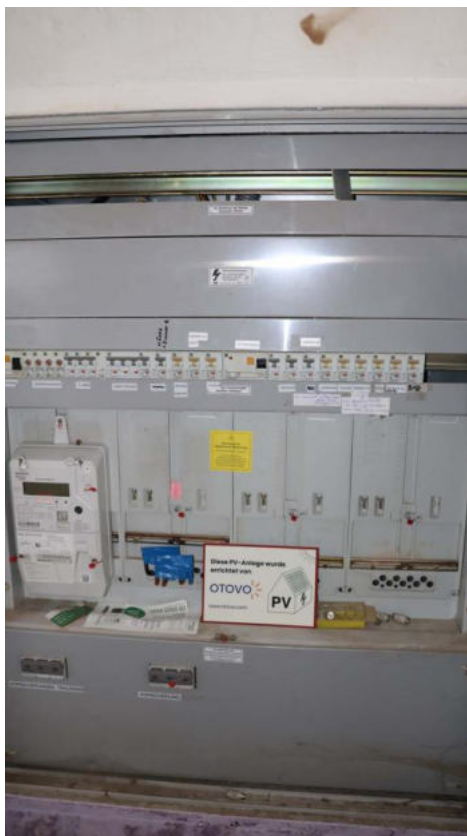
Bild 31 E-Verteiler in der EG Diele
