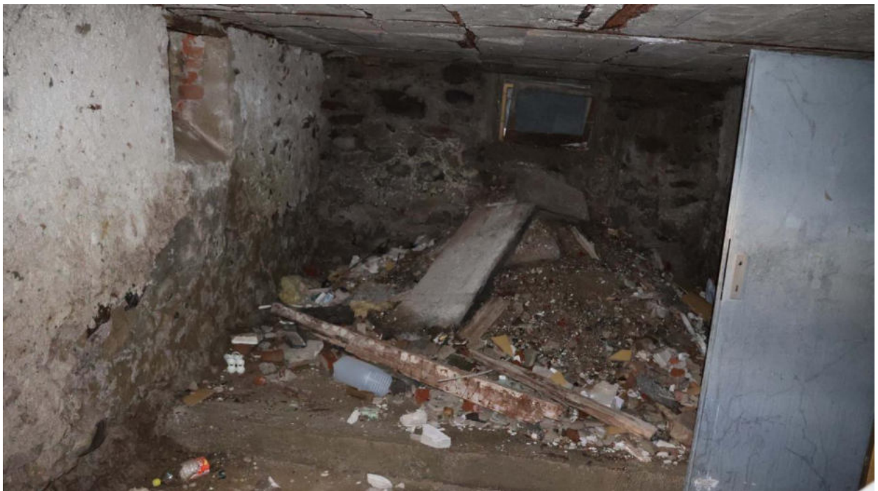
Bild 56 Schuttablagerungen im Keller
