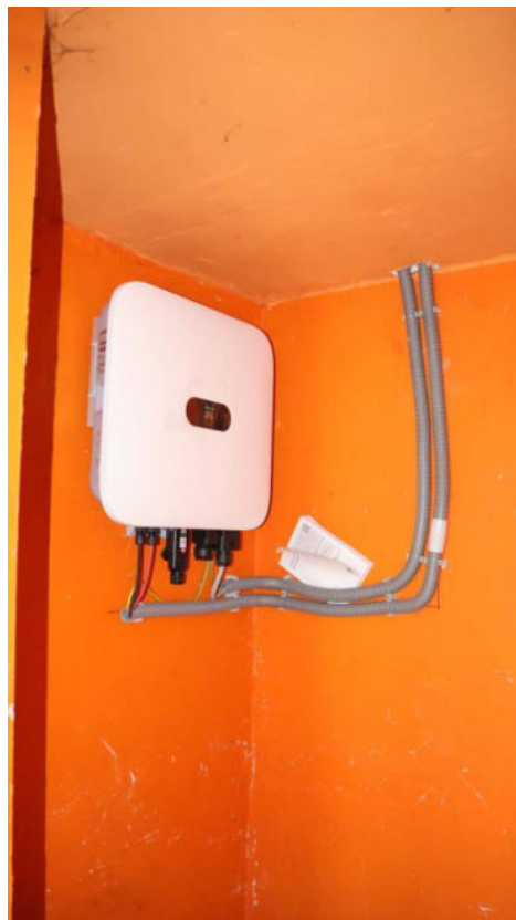
Wechselrichter PV-Anlage im DG
