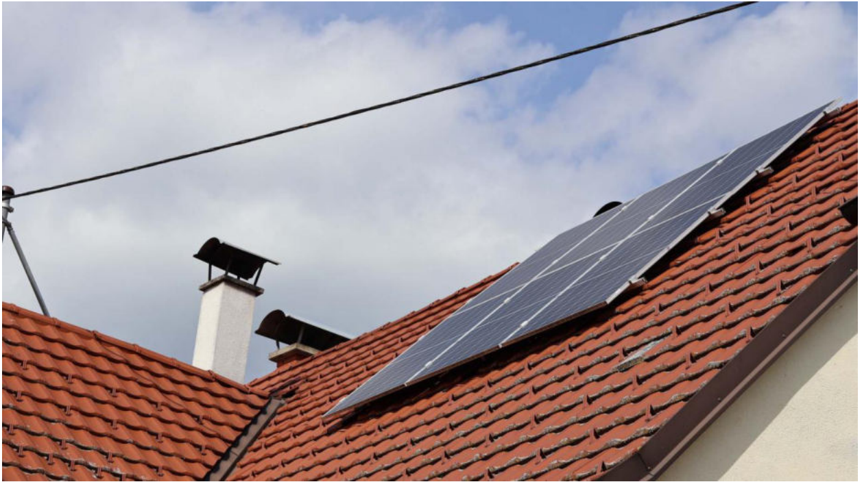
PV-Anlage an der Ostseite vom Wohnhausdach
