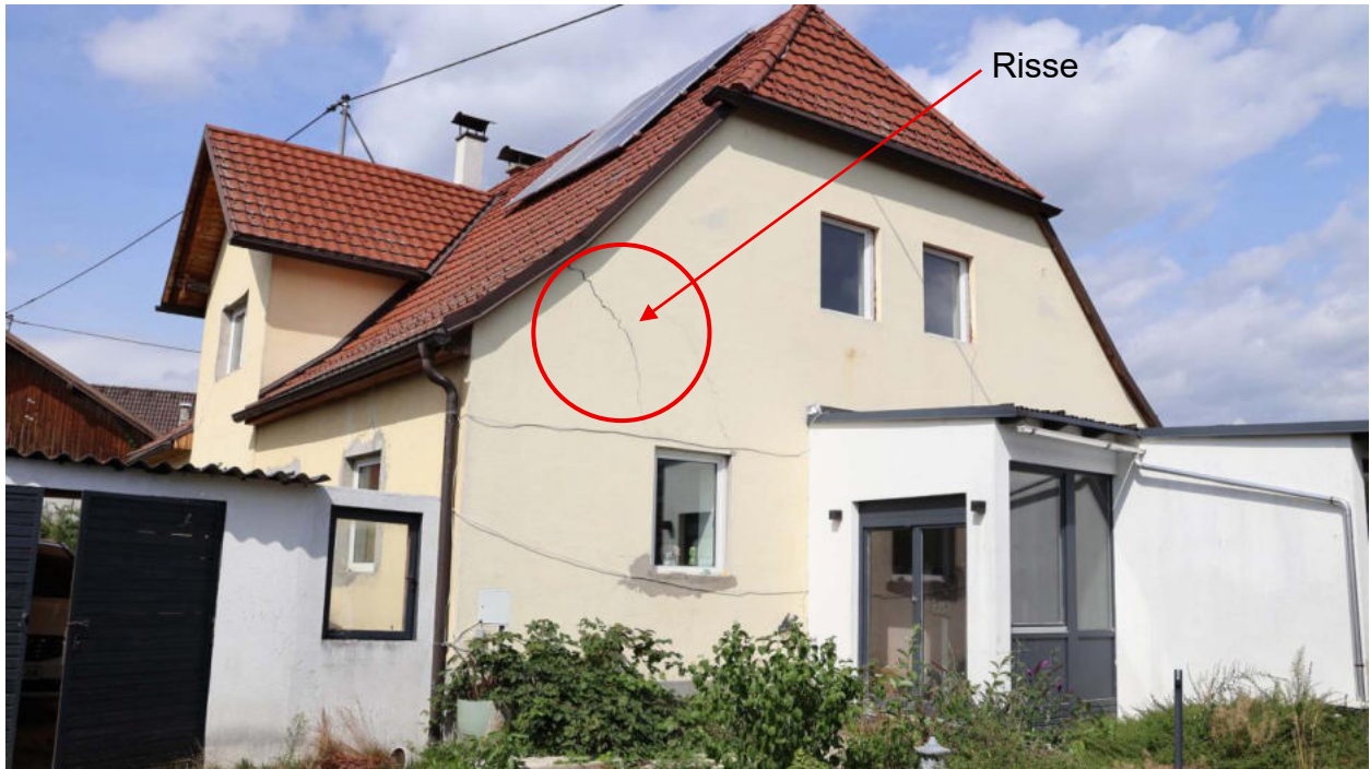
Gebäudeansicht von der Südostseite mit Rissbildungen in der Giebelwand
