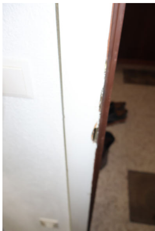
beschädigter Türstock W 22 Haus 2
