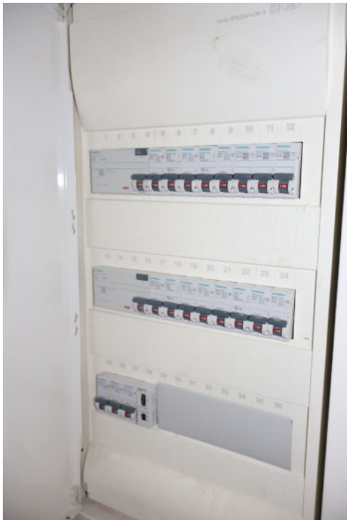
Vorraum Elektroverteiler W 22 Haus 2
