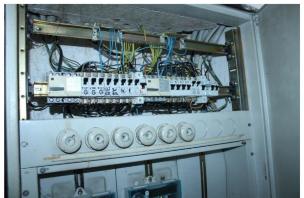
Fehlende Schutzabdeckung im Verteilerkasten
