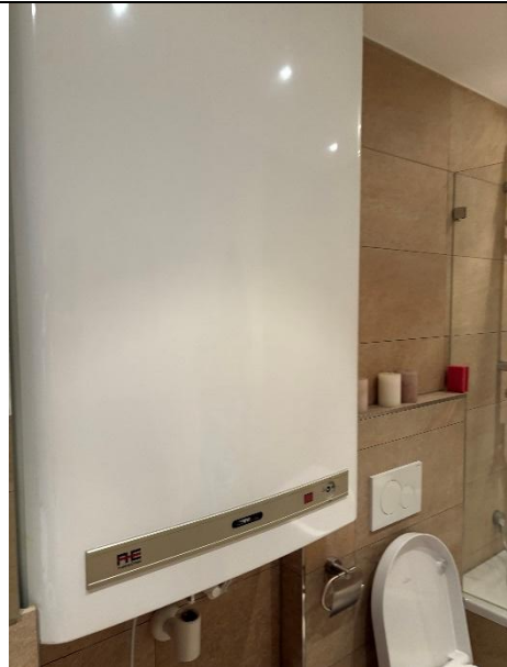
Abbildung 31: Boiler im Badezimmer (3/9)
