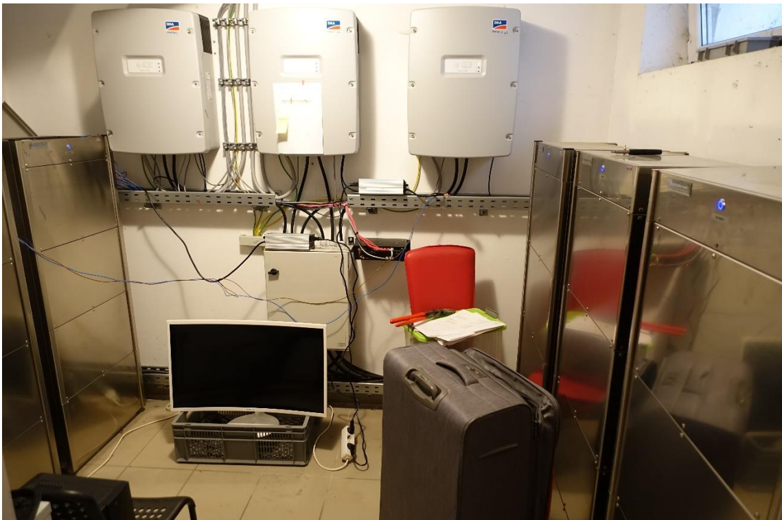
Foto 60 – Abstellraum mit Wechselrichter und Batteriespeicher
